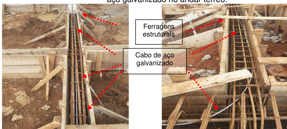
Figuras 84 e 85: Interligações entre as ferragens estruturais da edificação e o condutor de aço galvanizado no andar térreo.
