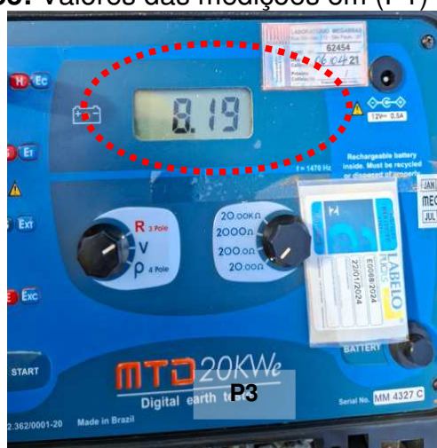
Figuras 356: Valores das medições em (P3) – POÇO ARTESIANO.
