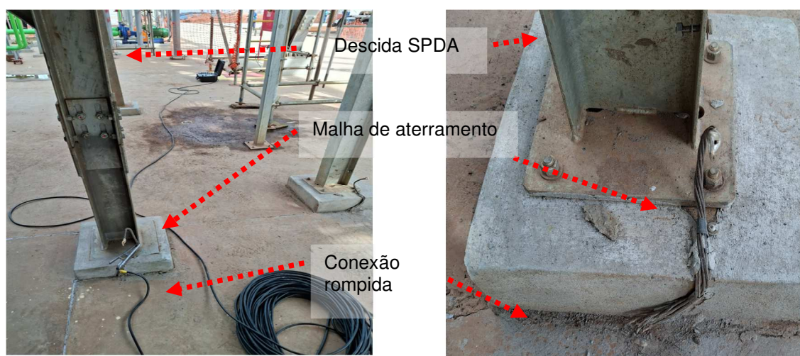
Figuras 294 e 295: Descida do SPDA rompida da malha de aterramento
