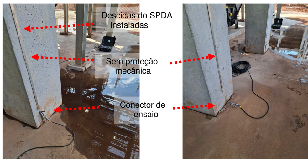
Figuras 260 e 261: Descidas convencionais do SPDA encontradas nesta inspeção.
