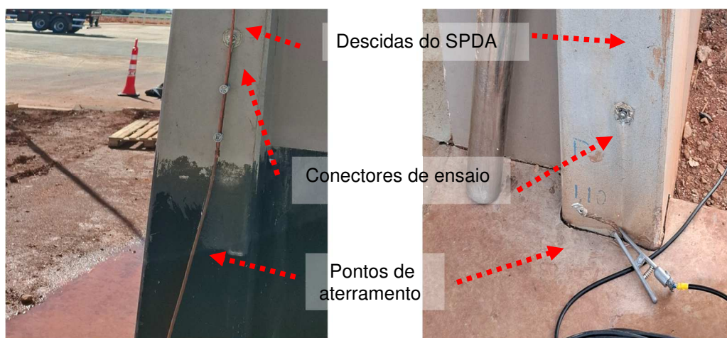
Figuras 362 e 363: Pontos de aterramento encontrados junto a base das descidas.
