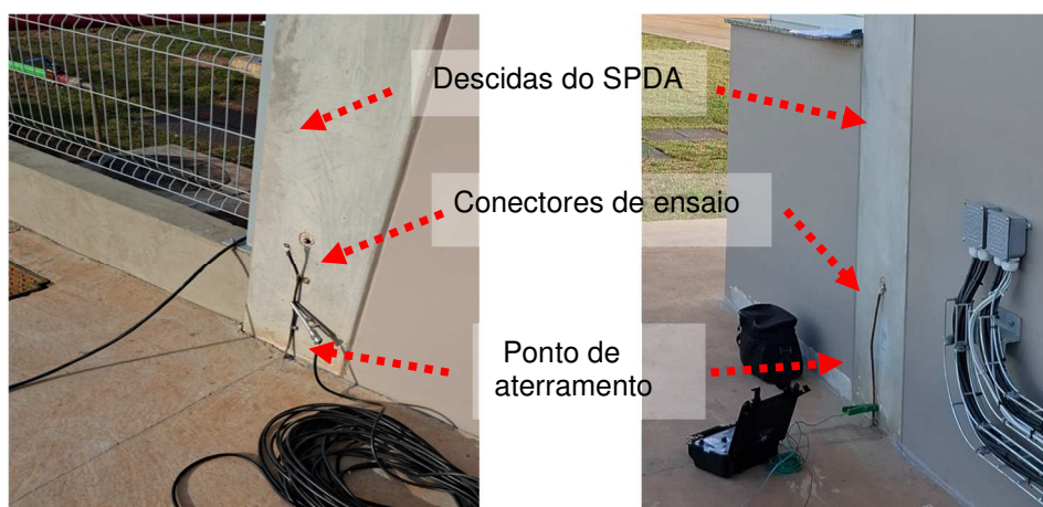
Figuras 488 e 489: Pontos de aterramento encontrados junto a base das descidas.
