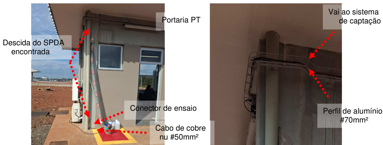
Figuras 473 e 474: Descida do SPDA instalada no prédio da Portaria PT.
