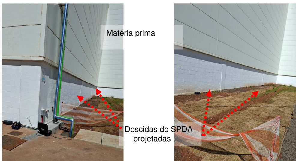
Figuras 15 e 16: Duas (02) descidas do SPDA projetadas não encontradas.
