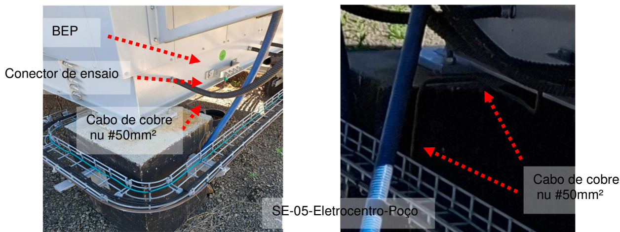
Figuras 502 e 503: Barra de equalização – Interligação com a malha de aterramento.
