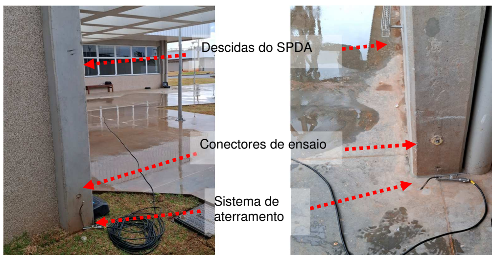
Figuras 122 e 123: Descidas do SPDA encontradas nesta inspeção.
