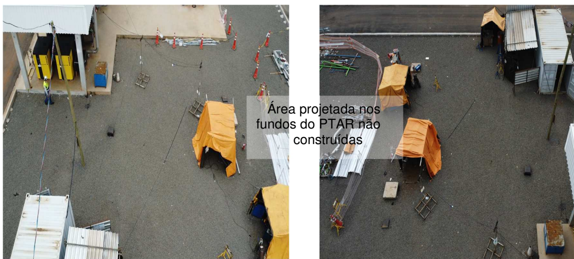
Figuras 198 e 199: Áreas projetadas nos fundos do PTAR não construídas.
