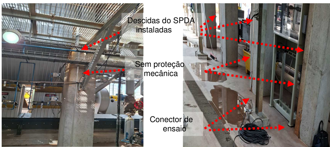
Figuras 266 e 267: Descidas convencionais do SPDA encontradas nesta inspeção.
