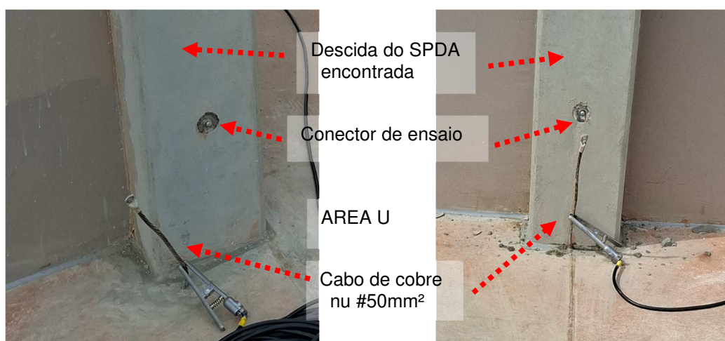
Figuras 177 e 178: Conexão da malha de aterramento com as descidas do SPDA
