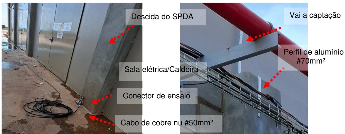
Figuras 321 e 322: Descidas do SPDA encontradas nesta inspeção.
