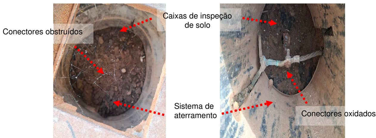
Figuras 162 e 163: Caixas de inspeção de solo com as conexões tampadas/oxidadas.
