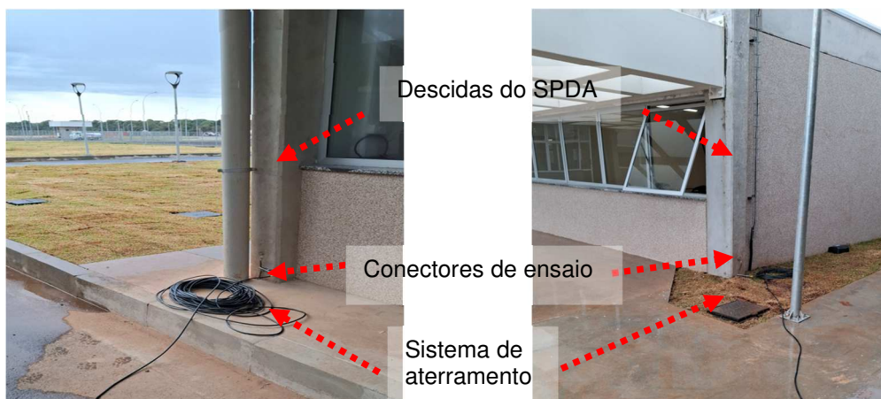
Figuras 120 e 121: Descidas do SPDA encontradas nesta inspeção.
