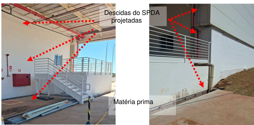
Figuras 11 e 12: Duas (02) descidas do SPDA projetadas não encontradas.
