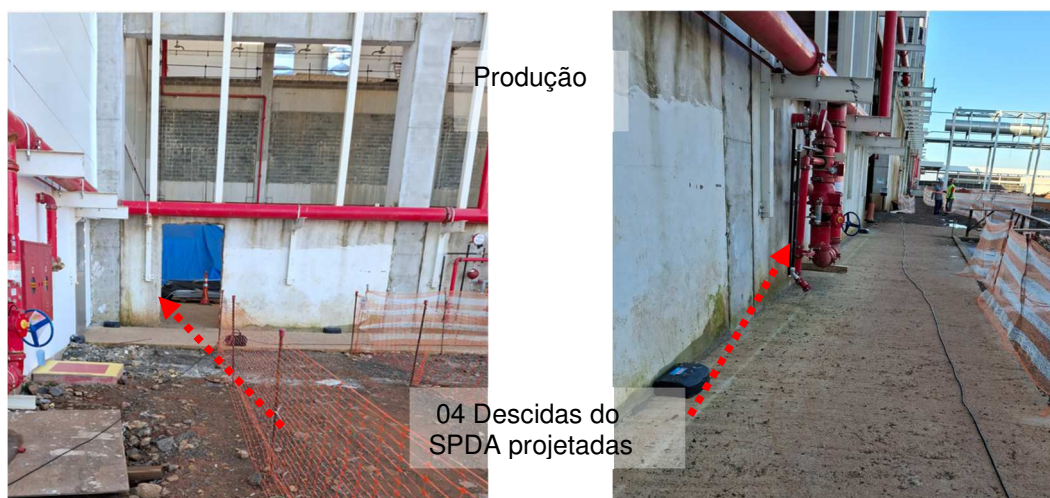
Figuras 24 e 25: 04 (quatro) descidas do SPDA projetadas não encontradas.
