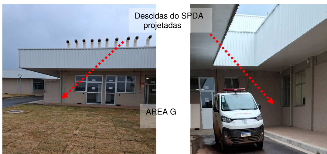
Figuras 100 e 101: Cinco (05) descidas do SPDA projetadas não encontradas
