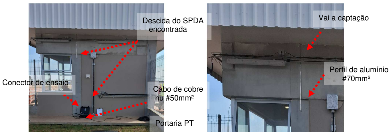
Figuras 471 e 472: Descida do SPDA instalada no prédio da Portaria PT.
