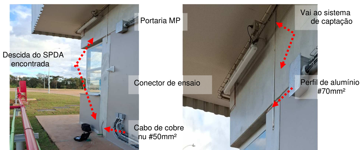
Figuras 486 e 487: Descida do SPDA instalada no prédio da Portaria MP.
