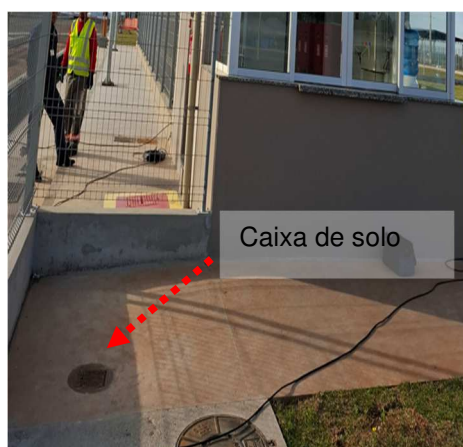
Figura 490: Caixa de inspeção de solo
