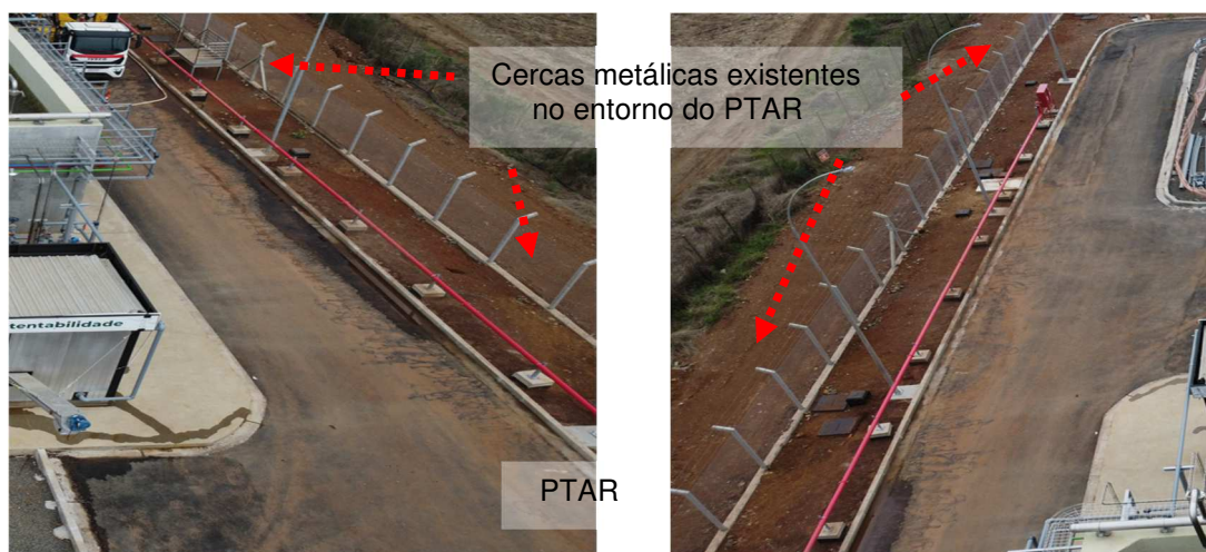
Figuras 248 e 249: Estruturas metálicas com aterramento projetado não visualizado.
