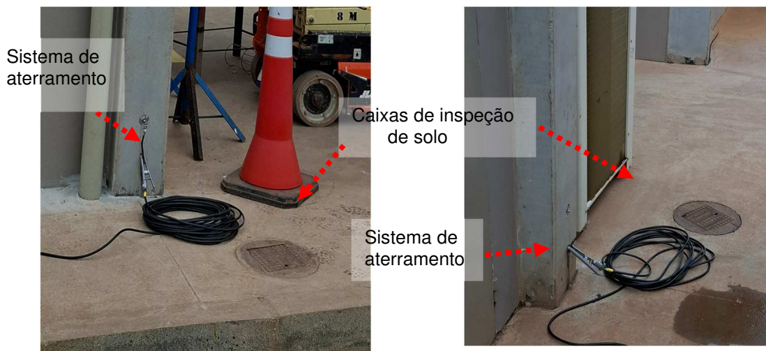
Figuras 259 e 260: Tampas das caixas de solo emperradas.
