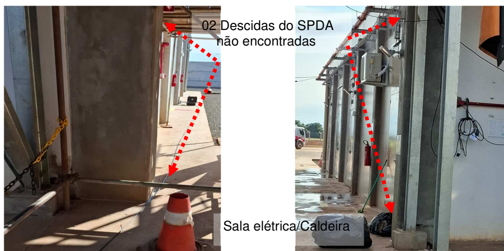
Figuras 323 e 324: 02 (duas) descidas do SPDA projetadas não encontradas.
