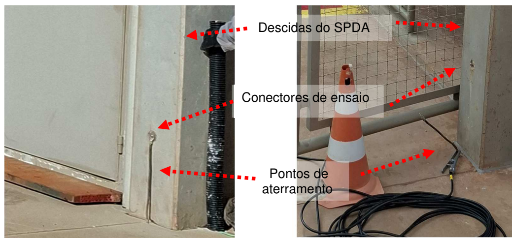
Figuras 390 e 391: Pontos de aterramento encontrados junto a base das descidas.
