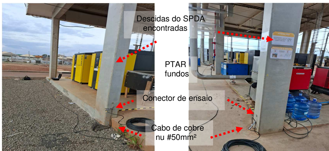
Figuras 216 e 217: Descidas do SPDA instalada no prédio do PTAR fundos.
