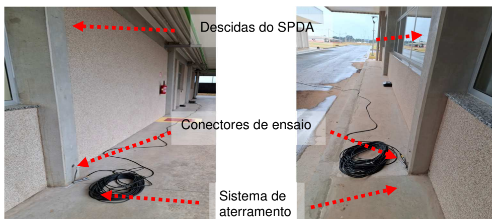
Figuras 118 e 119: Descidas do SPDA encontradas nesta inspeção.
