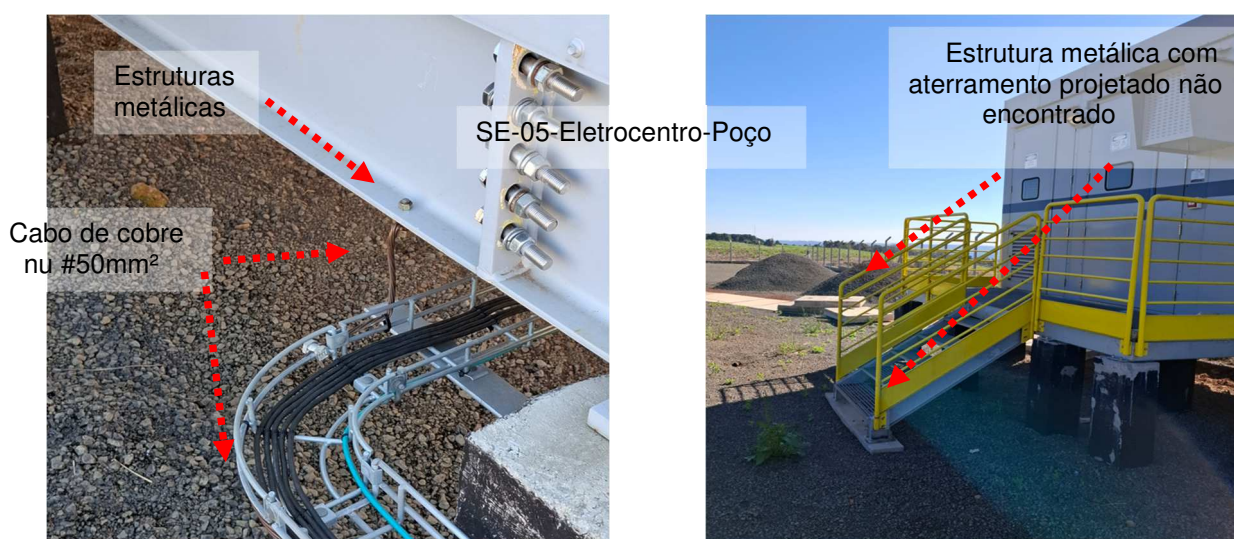
Figuras 510 e 511: Aterramento não constante em planta//aterrar /interligar escada ao SPDA
