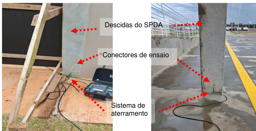
Figuras 128 e 129: Descidas do SPDA encontradas nesta inspeção.
