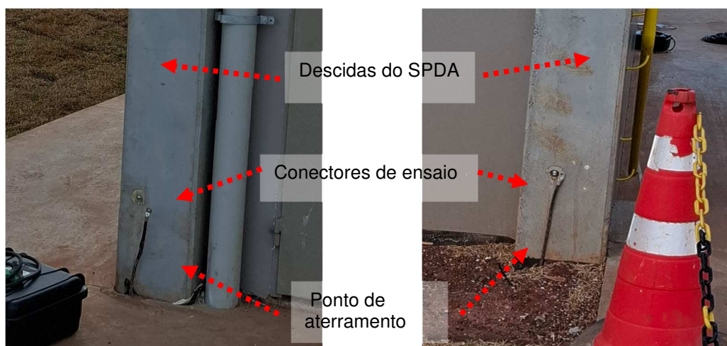
Figuras 360 e 361: Pontos de aterramento encontrados junto a base das descidas.
