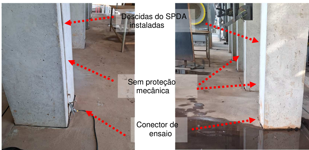
Figuras 264 e 265: Descidas convencionais do SPDA encontradas nesta inspeção.
