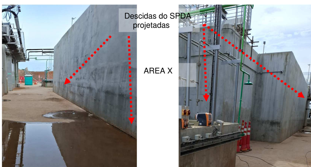
Figuras 216 e 217: Pontos das descidas do SPDA projetadas não encontradas.
