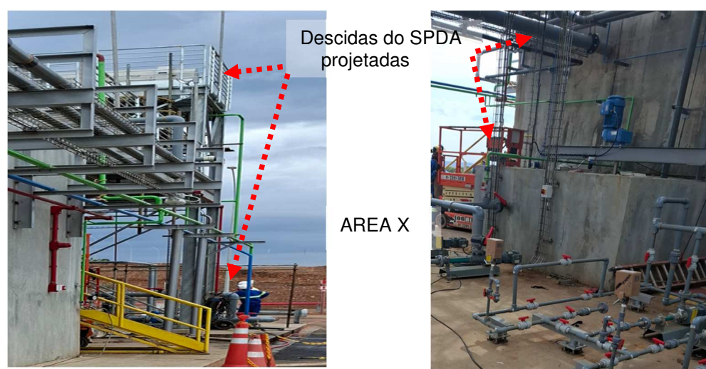
Figuras 218 e 219: Pontos das descidas do SPDA projetadas não encontradas
