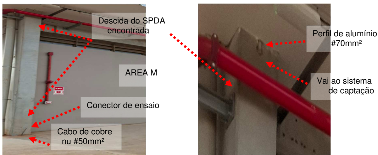
Figuras 150 e 151: Descida do SPDA encontrada nesta inspeção.
