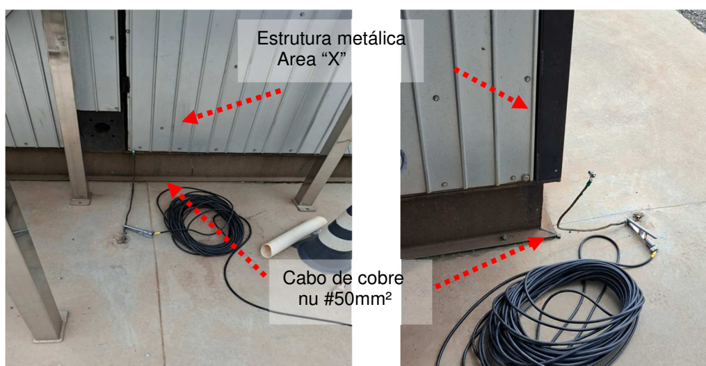
Figuras 237 e 238: Conexão da malha de aterramento com estrutura metálica.
