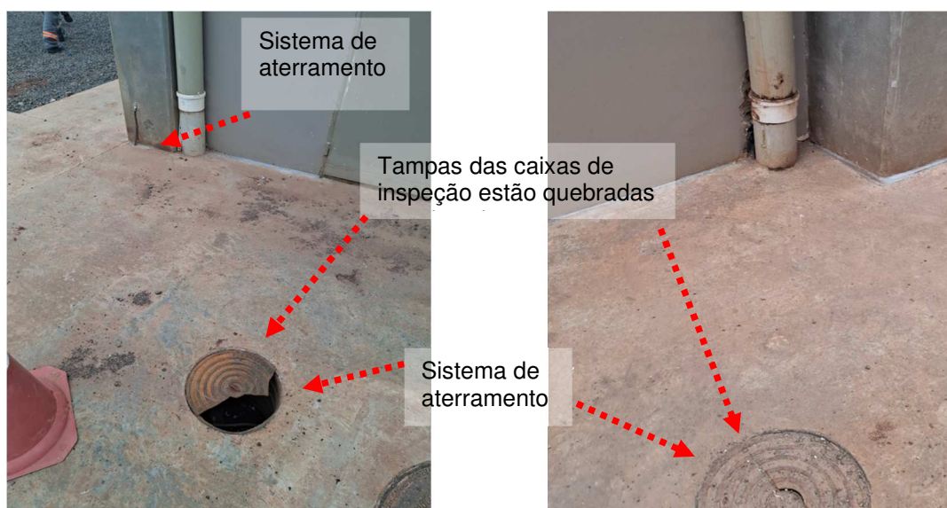
Figuras 333 e 334: Tampas das caixas de solo estão quebradas.
