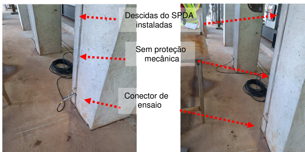
Figuras 262 e 263: Descidas convencionais do SPDA encontradas nesta inspeção.
