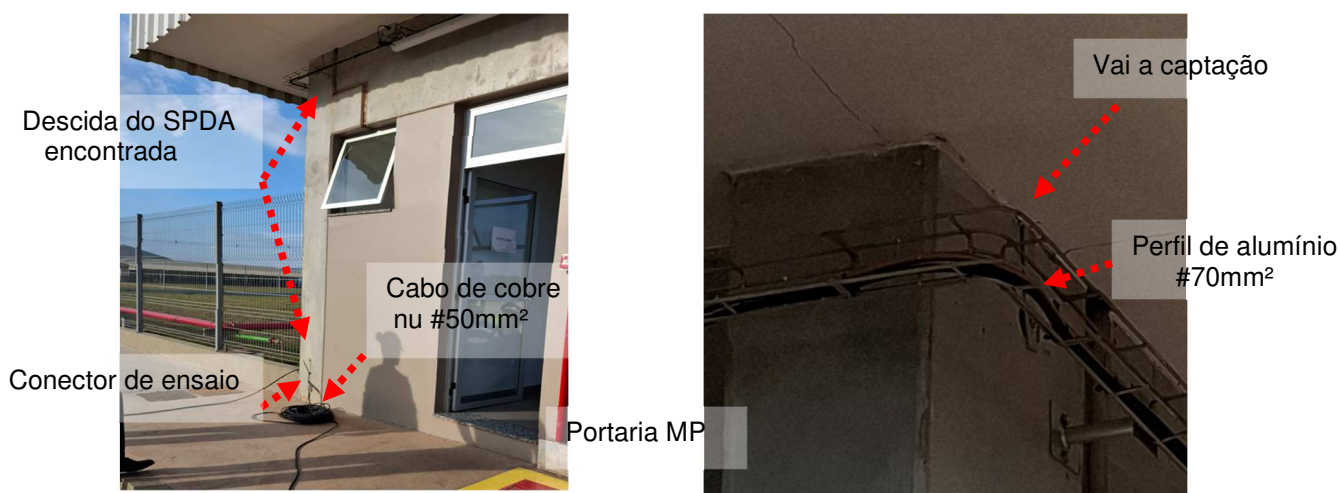
Figuras 484 e 485: Descida do SPDA instalada no prédio da Portaria MP.
