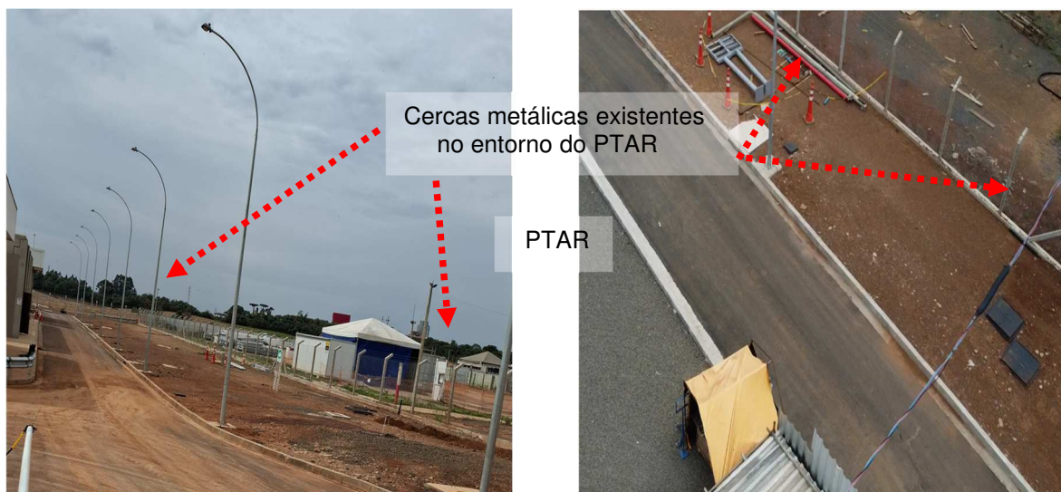
Figuras 250 e 251: Estruturas metálicas com aterramento projetado não visualizado.
