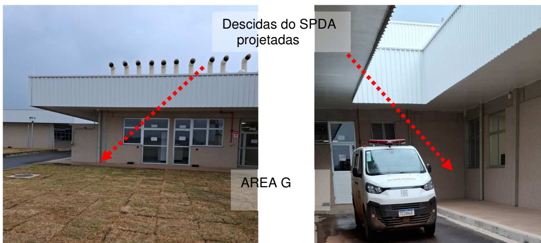
Figuras 49 e 50: Cinco (05) descidas do SPDA projetadas não encontradas
