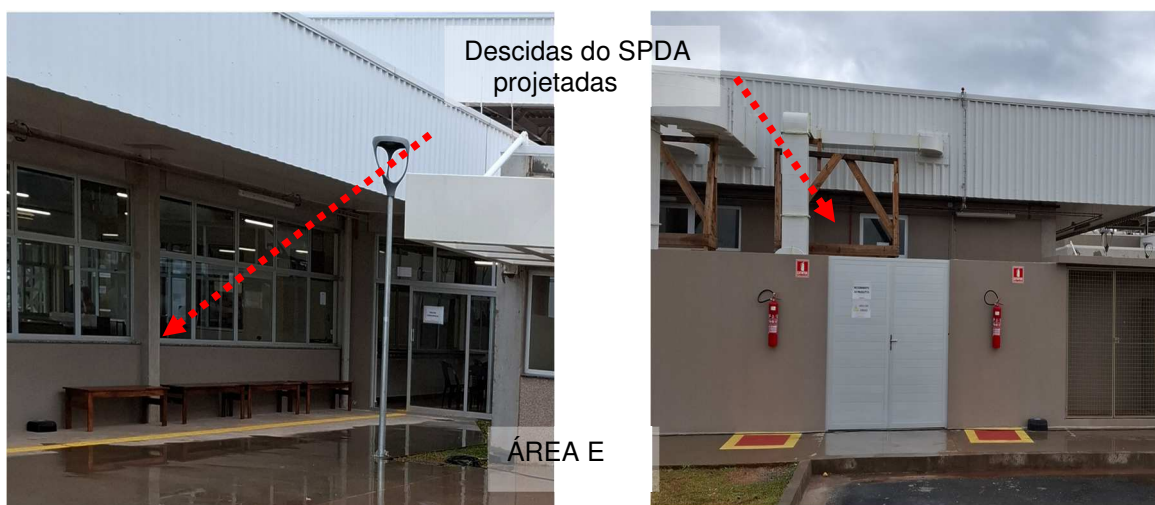
Figuras 51 e 52: 02 (duas) descidas do SPDA projetadas não encontradas.
