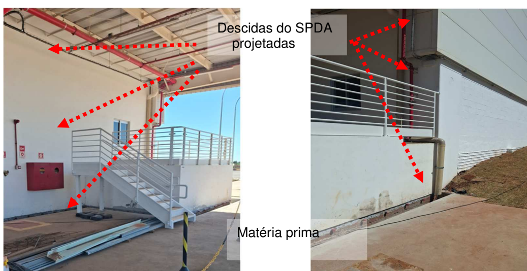
Figuras 05 e 06: Duas (02) descidas do SPDA projetadas não encontradas.
