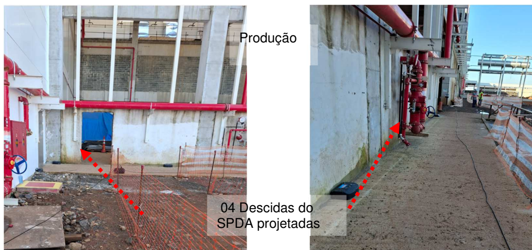
Figuras 18 e 19: 04 (quatro) descidas do SPDA projetadas não encontradas.
