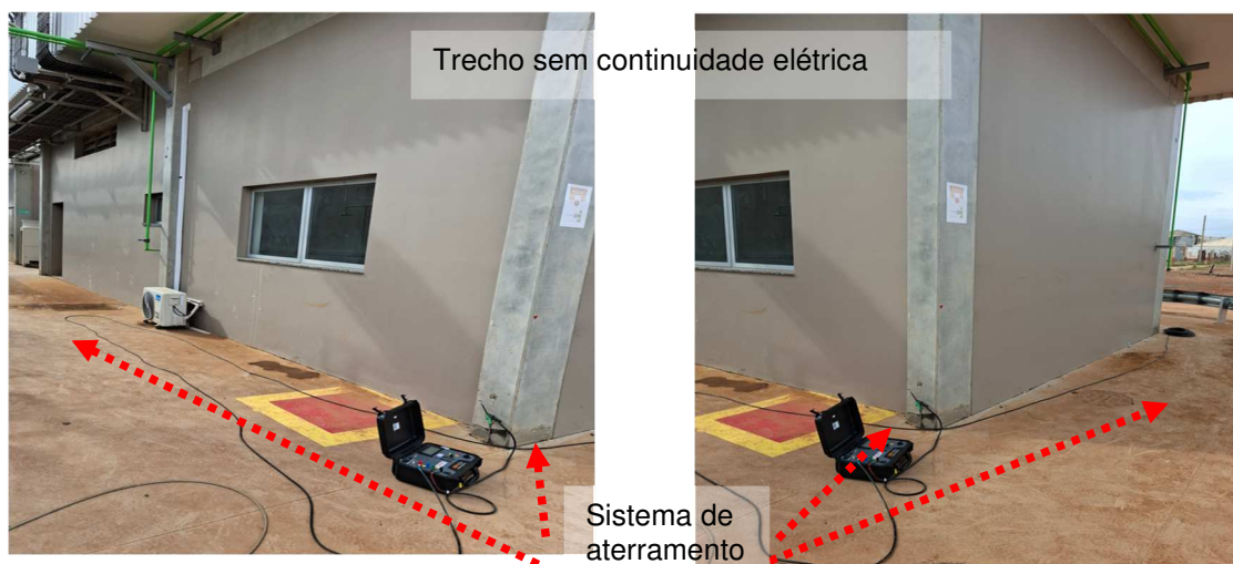
Figuras 82 e 83: Sistema de aterramento -Trecho sem continuidade elétrica.
