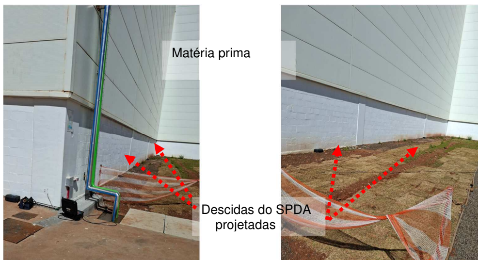
Figuras 09 e 10: Duas (02) descidas do SPDA projetadas não encontradas.
