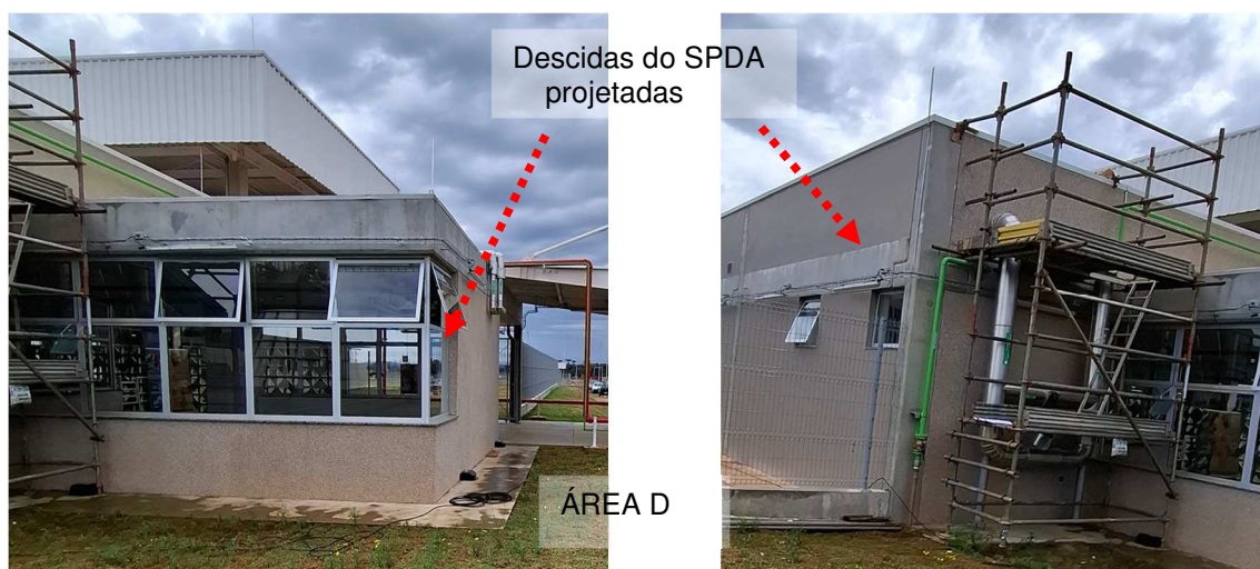
Figuras 53 e 54: 02 (duas) descidas do SPDA projetadas não encontradas.
