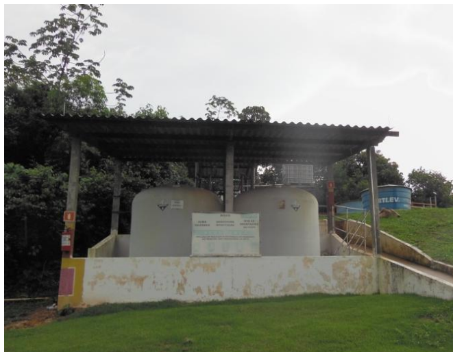
Figura 11: Área do Tanque dos Ácidos
