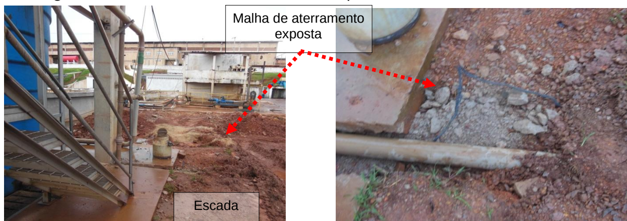
Figura 15 e 16: Malha de aterramento rompida no Pavilhão do ETE, próximo a escada.
