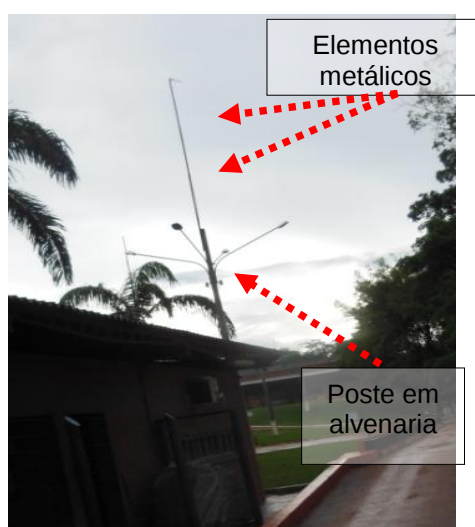
Figuras 03: Elementos metálicos não integrados ao SPDA.
