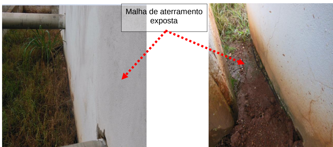
Figuras 21 e 22: Malha de aterramento exposta - Interligação com o compressor
