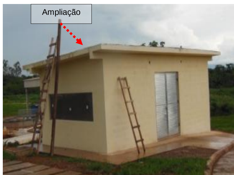
Figura 29: Sala de Painéis (Nova) - Ampliação não consta em projeto e não integrada ao SPDA
