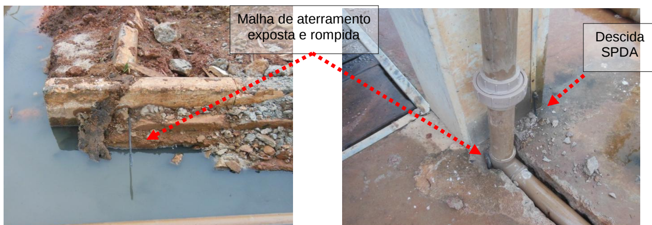
Figura 13 e 14: Malha de aterramento rompida na área do Pavilhão do ETE.
