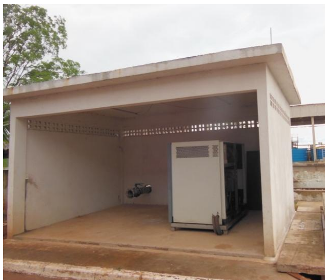
Figura 18: Área do Compressor do ETE
