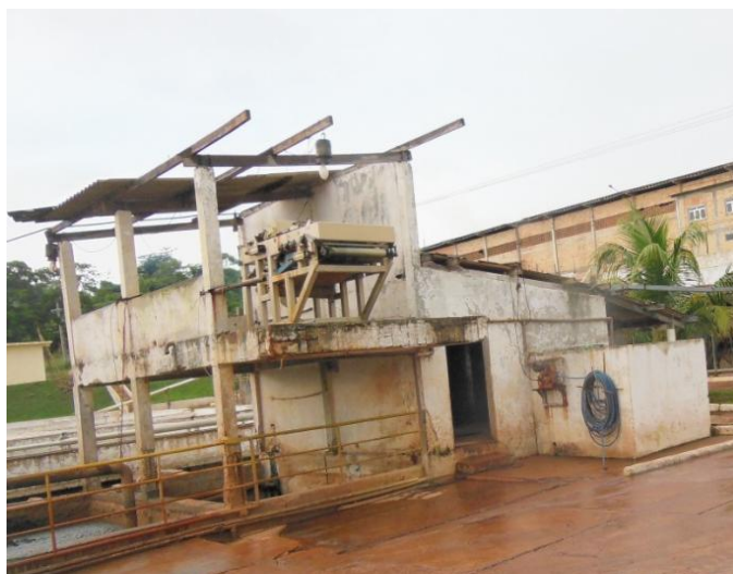
Figura 17: Área da Sala de Painéis
