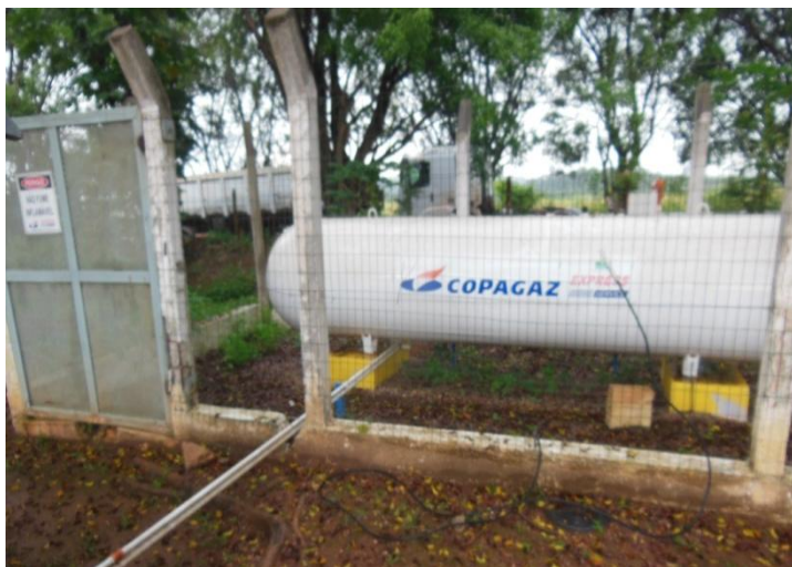
Figura 28: Área do Tanque de Gás
