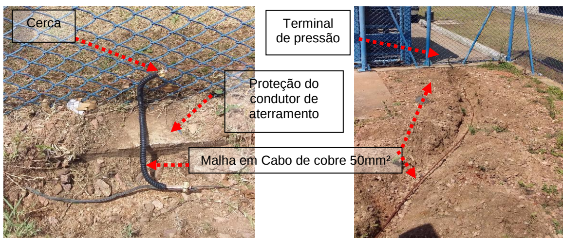
Figuras 08 e 09: Interligações realizadas com a malha de aterramento implantada.
