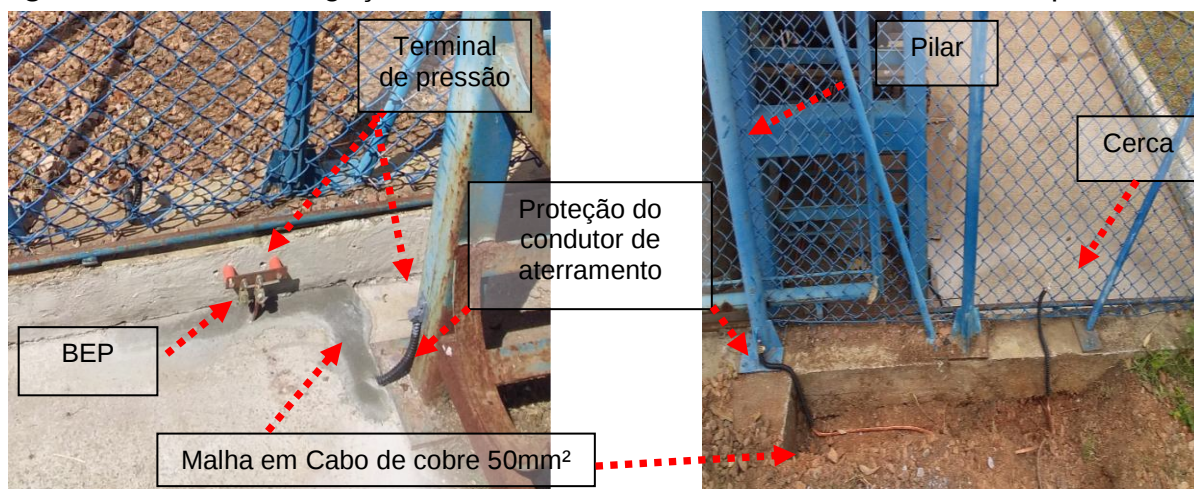
Figuras 04 e 05: Interligações realizadas com a malha de aterramento implantada.
