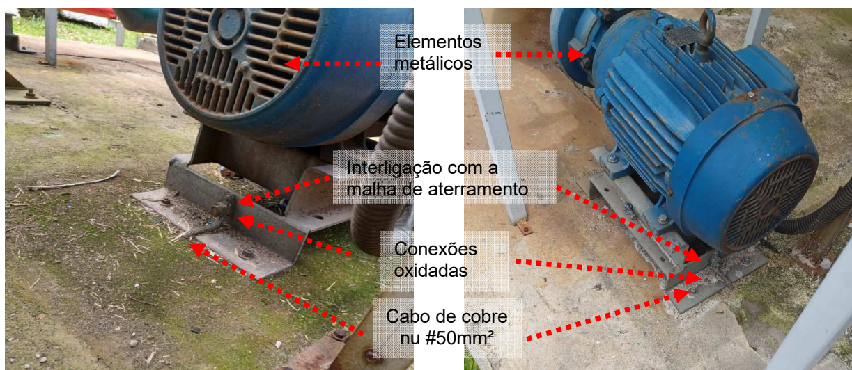
Figuras 137 e 138: Sistema de aterramento -Interligação da malha de aterramento com elementos metálicos encontram-se oxidadas.
