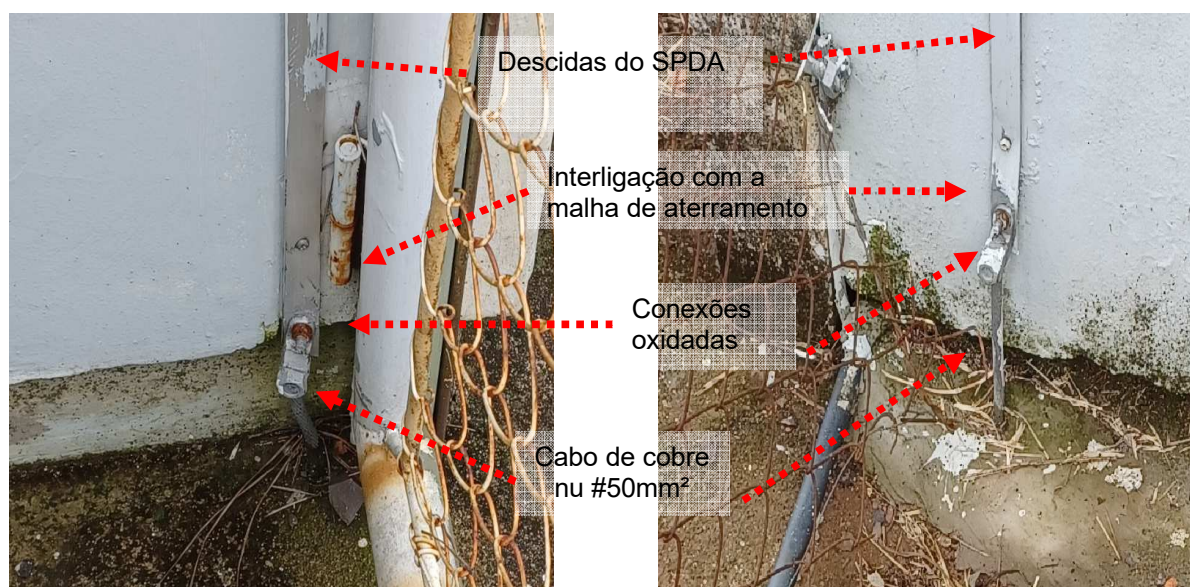
Figuras 29 e 30: Sistema de aterramento -Interligação da malha de aterramento com as descidas do SPDA encontram-se oxidadas.
