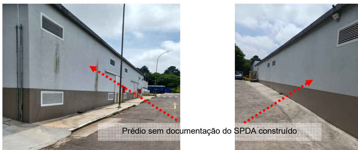
Figuras 340 e 341: Prédio sem documentação do SPDA construído.
