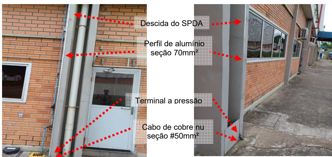
Figuras 119 e 120: Sistema de descidas existente – Pavilhão Não tecidos.
