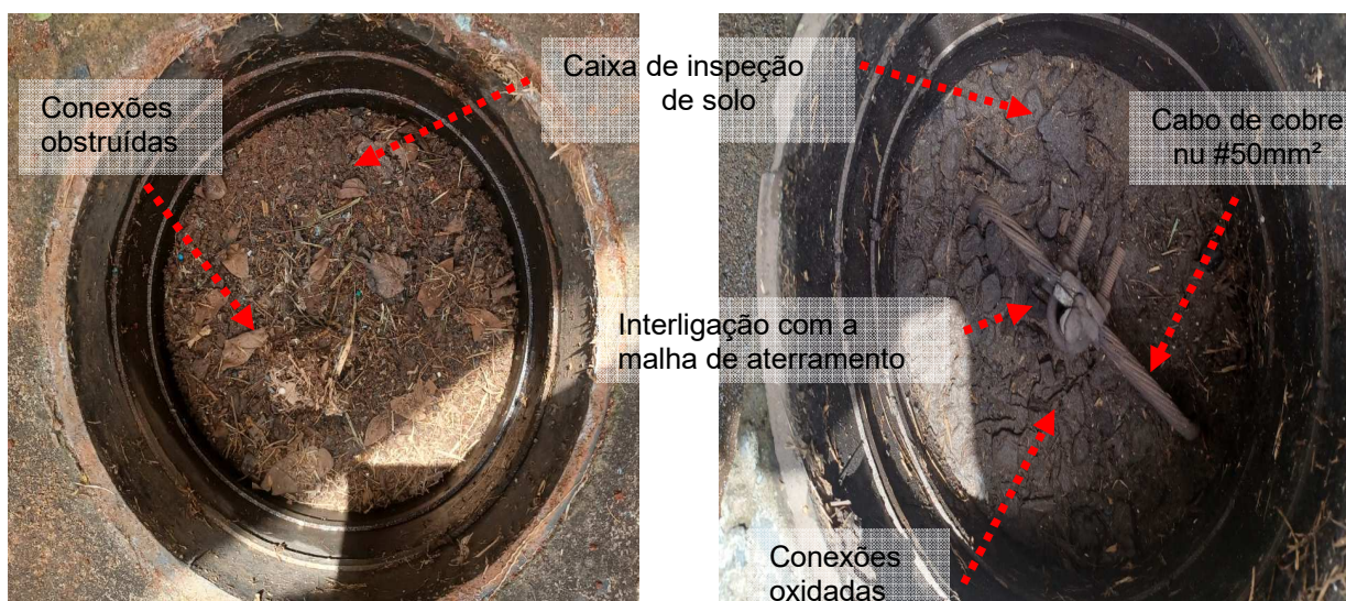
Figuras 52 e 53: Sistema de aterramento -Conexões obstruídas / Oxidadas no interior das caixas de inspeção de solo.
