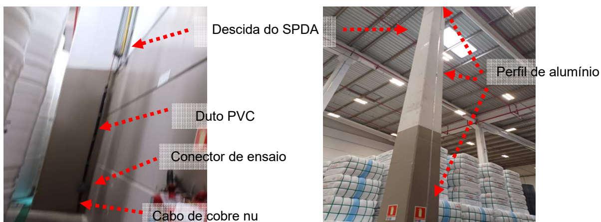
Figuras 77 e 78: Sistema de Descidas – RS8 (Parte interna).
