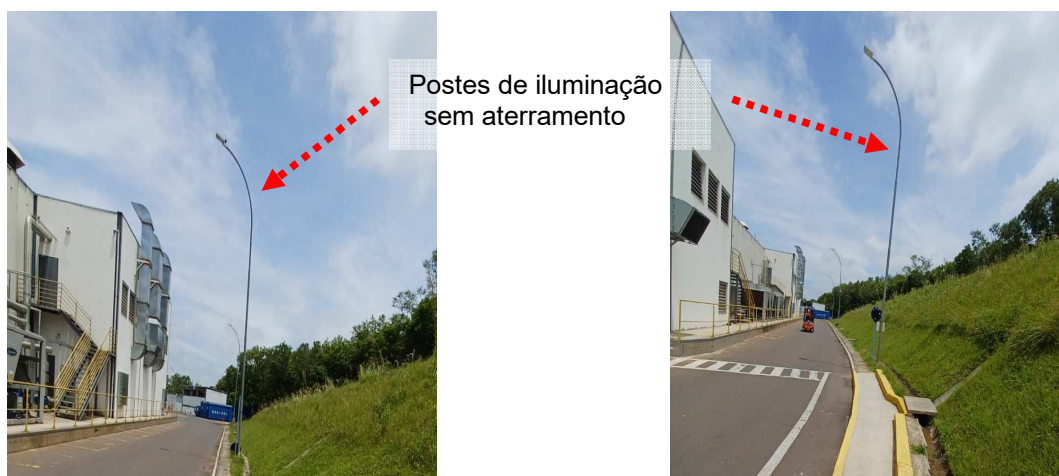
Figuras 335 e 336: Poste de iluminação sem aterramento.
