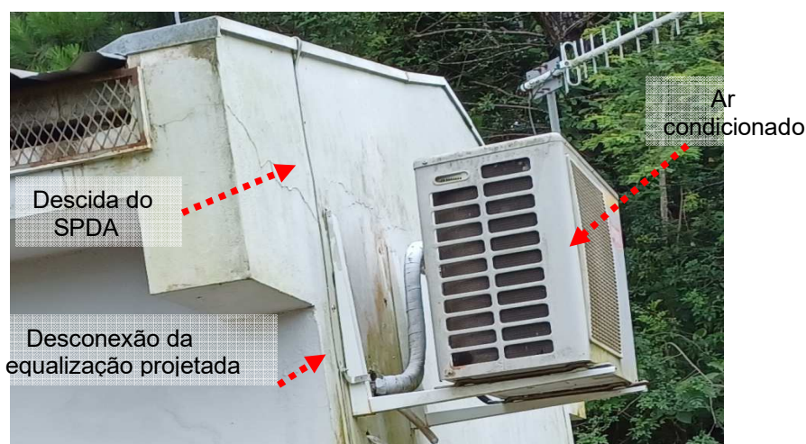
Figura 28: Desconexão da equalização projetada entre elemento metálico e a descida do SPDA
