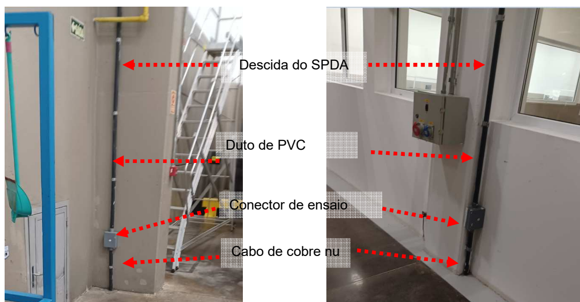
Figuras 75 e 76: Sistema de Descidas – RS8 (Parte interna).
