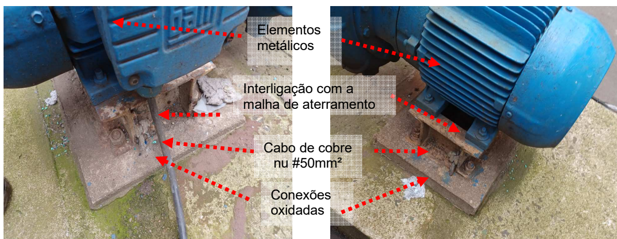
Figuras 260 e 261: Sistema de aterramento -Interligação da malha de aterramento com elementos metálicos (motores) encontram-se oxidadas.
