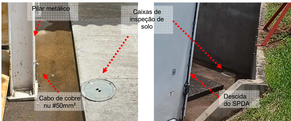
Figuras 49 e 50: Sistema de aterramento – Caixa de inspeção de solo Interligação malha de terra com elemento metálico através de cabo de cobre nu #50mm 2
