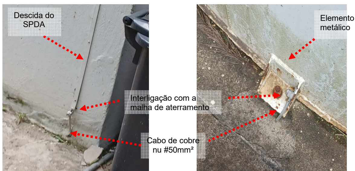
Figuras 39 e 40: Interligação da malha de aterramento natural com a descida do SPDA e elemento metálico (Tanque).
