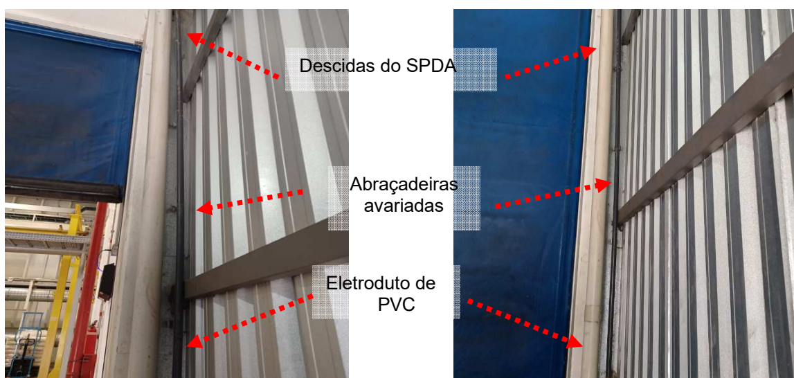
Figuras 193 e 194: Sistema de descidas Fixação precária dos eletrodutos de proteção das descidas do SPDA na alvenaria.
