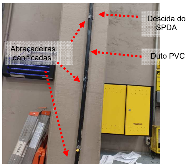
Figura 87: Sistema de descidas – Fixação fragilizada na alvenaria
