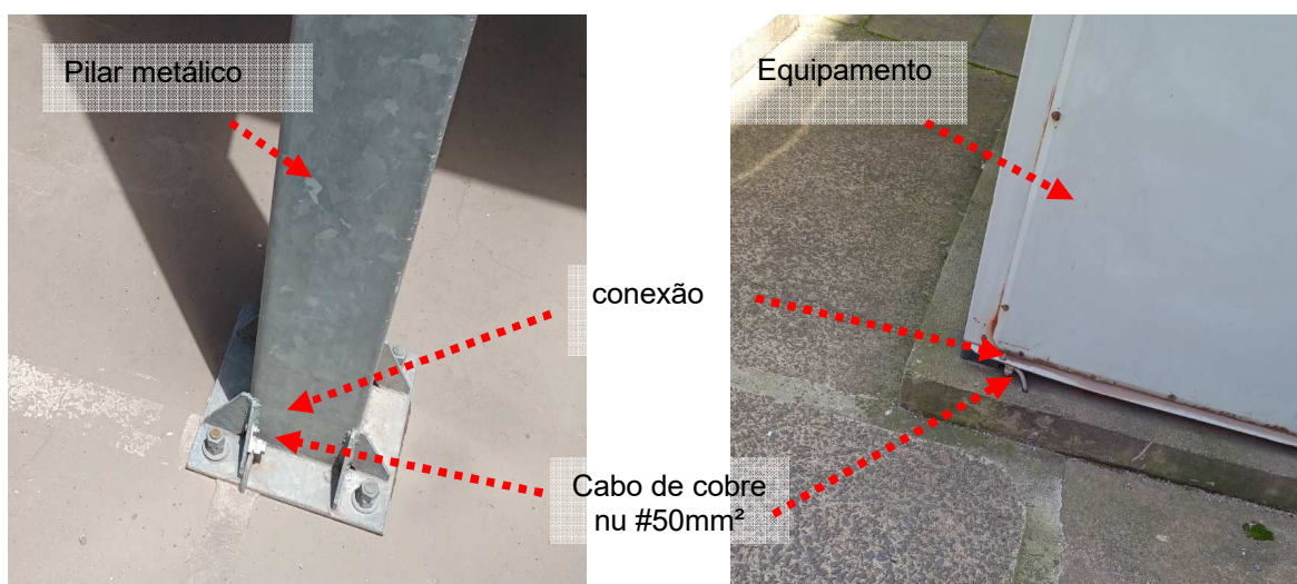
Figuras 183 e 184: Sistema de aterramento
