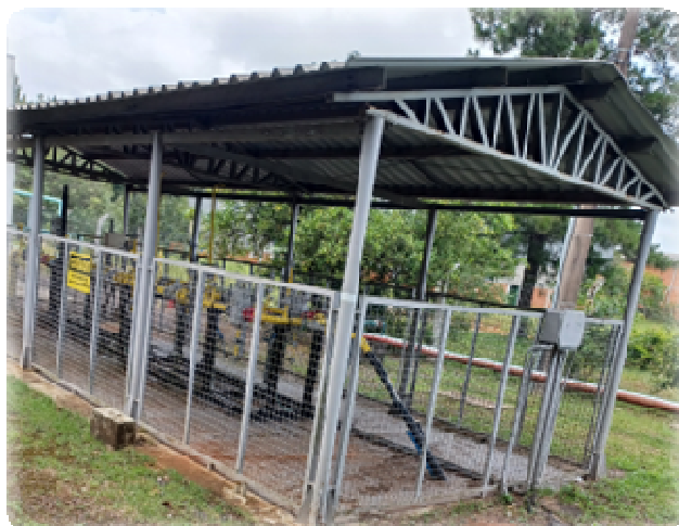
Figura 273: Central de gás
