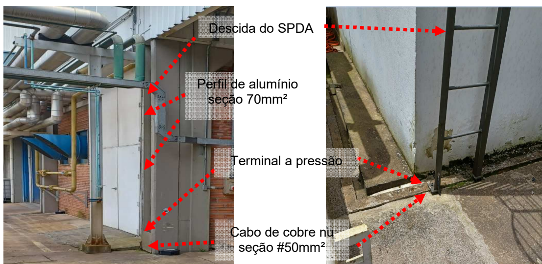
Figuras 123 e 124: Sistema de descidas existente – Pavilhão Não tecidos.
