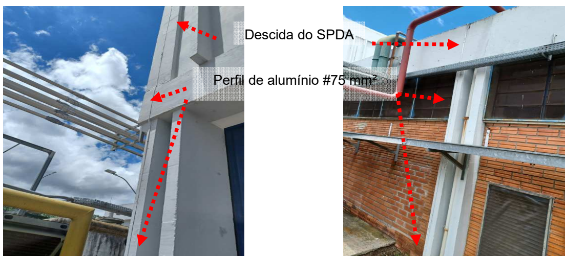
Figuras 115 e 116: Sistema de descidas existente – Pavilhão Não tecidos.
