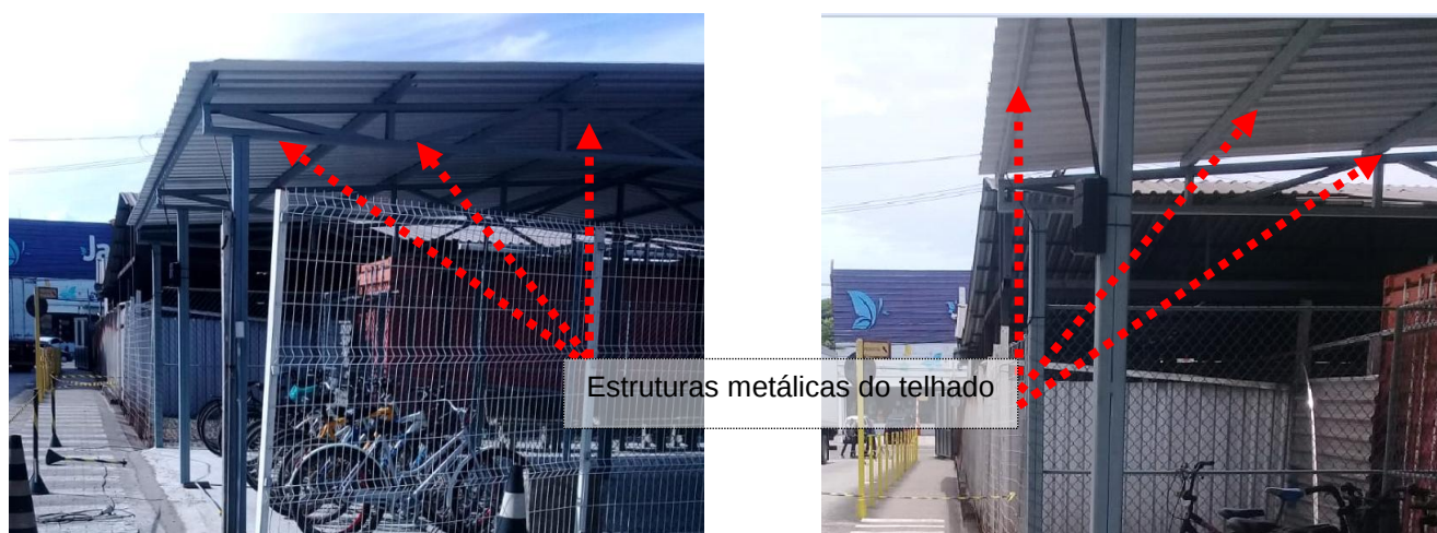
Figuras 76 e 77: Sistema Captor natural através das estruturas metálicas do telhado.
