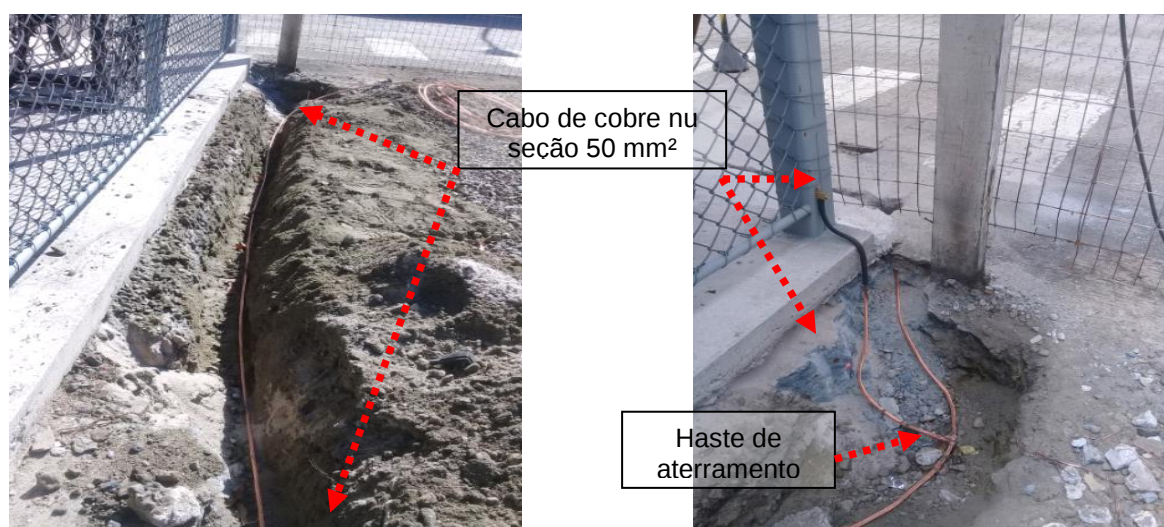
Figuras 90 e 91: Malha de aterramento implantada em cobre nu seção # 50mm 2 .
