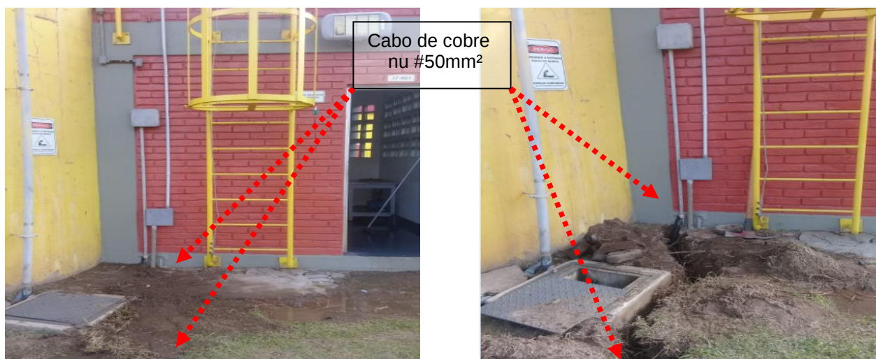
Figura 210 e 211: Malha de aterramento implantada em cobre nu seção # 50mm 2 .
