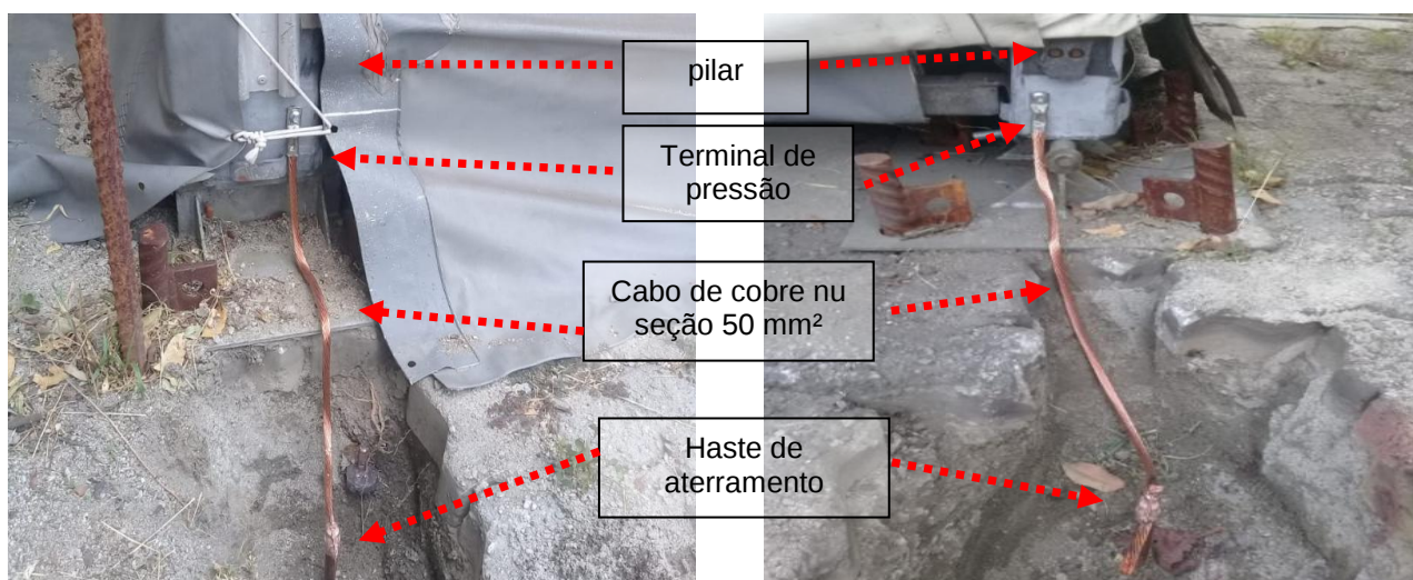
Figuras 352 e 353: Aterramento pilar metálico – Galpão Provisório
