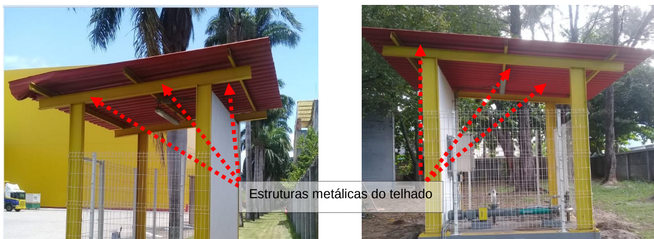
Figuras 305 e 306: Sistema Captor natural através das estruturas metálicas do telhado.
