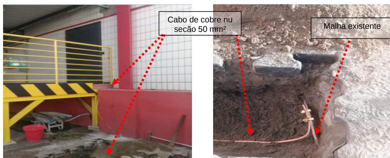
Figuras 294 e 295: Malha de aterramento implantada em cobre nu seção # 50mm 2 .
