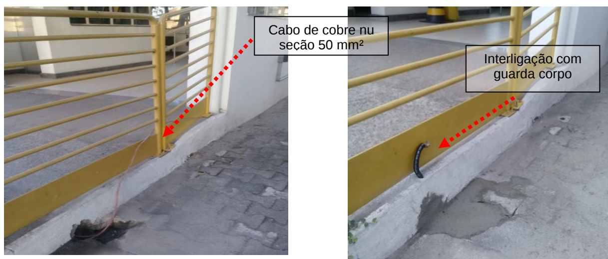
Figuras 142 e 143: Malha de aterramento implantada em cobre nu seção # 50mm 2 .
