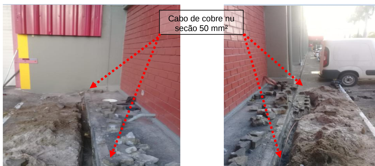
Figuras 183 e 184: Malha de aterramento implantada em cobre nu seção # 50mm 2 .
