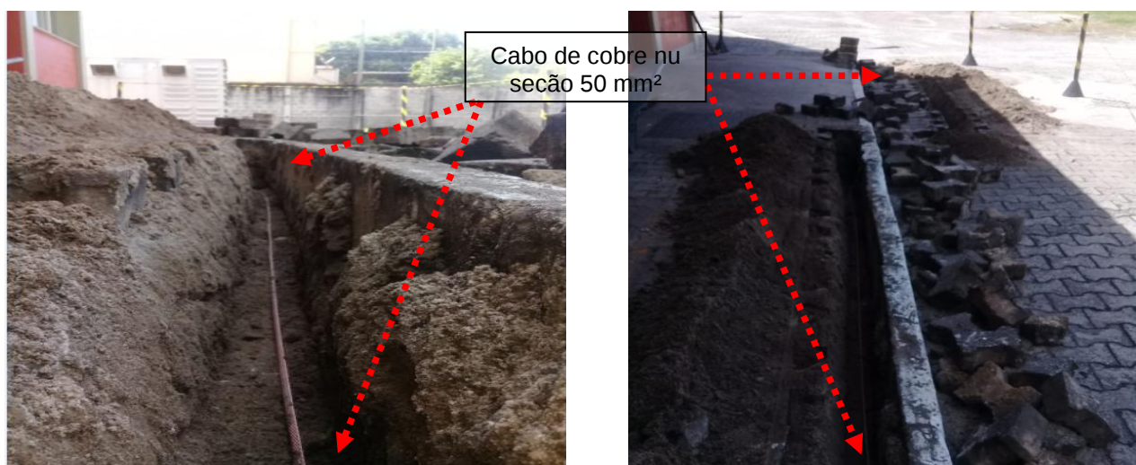
Figuras 173 e 174: Malha de aterramento implantada em cobre nu seção # 50mm 2 .
