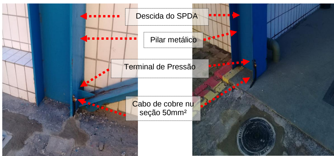
Figuras 45 e 46: Descida natural Implantada através de pilar metálico da edificação.
