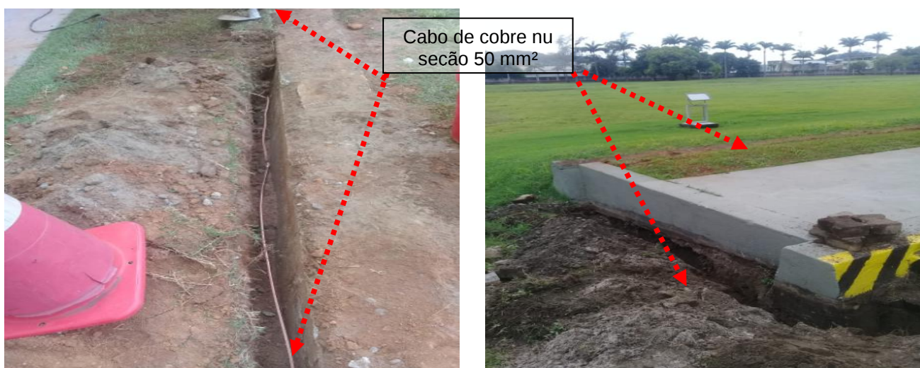
Figuras 278 e 279: Malha de aterramento implantada em cobre nu seção # 50mm 2 .
