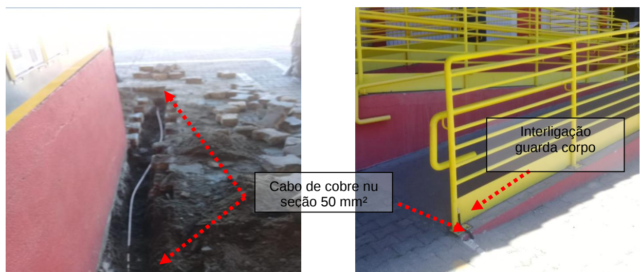
Figuras 234 e 235: Malha de aterramento implantada em cobre nu seção # 50mm 2 .
