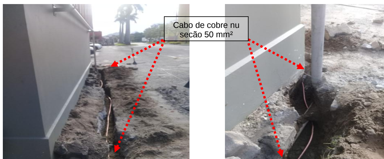
Figuras 181 e 182: Malha de aterramento implantada em cobre nu seção # 50mm 2 .
