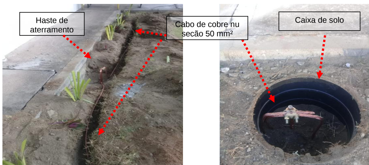
Figuras 124 e 125: Malha de aterramento implantada em cobre nu seção # 50mm 2 .
