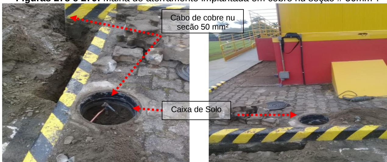
Figuras 280 e 281: Malha de aterramento implantada em cobre nu seção # 50mm 2 .
