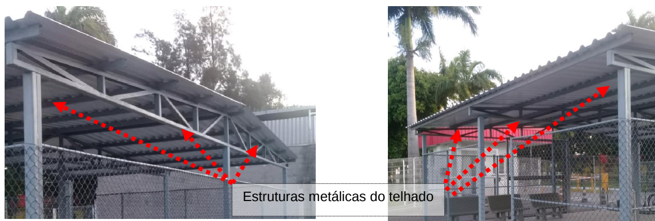
Figuras 74 e 75: Sistema Captor natural através das estruturas metálicas do telhado.
