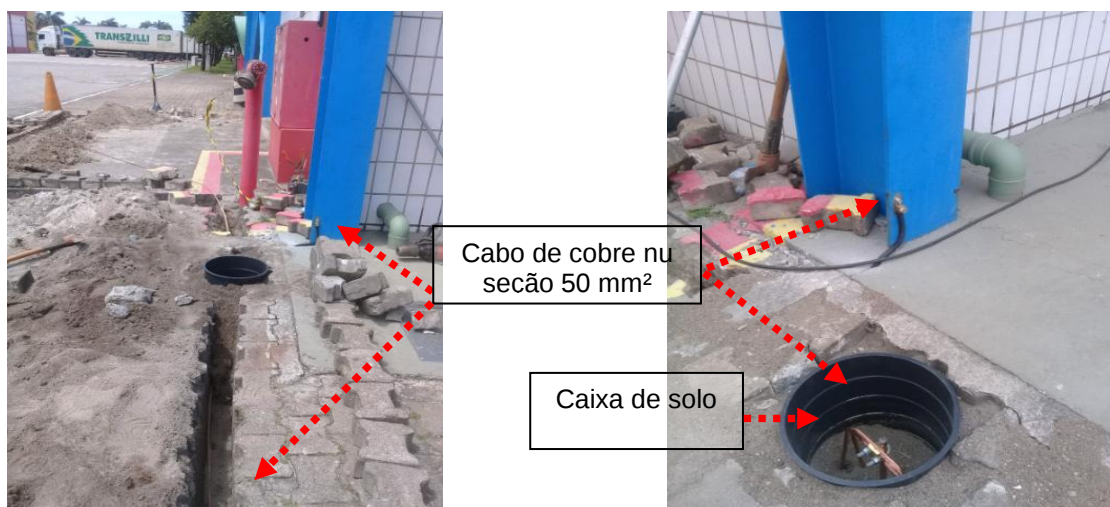
Figuras 53 e 54: Malha de aterramento implantada em cobre nu seção # 50mm 2 .
