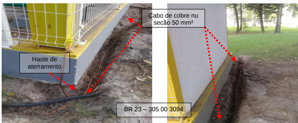
Figuras 333 e 334: Malha de aterramento implantada em cobre nu seção # 50mm 2 .
