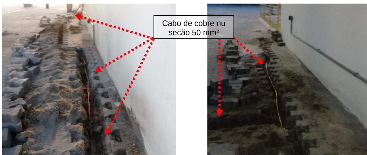
Figuras 140 e 141: Malha de aterramento implantada em cobre nu seção # 50mm 2 .
