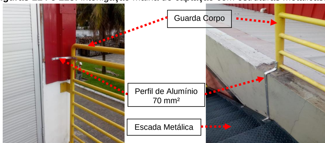
Figuras 116 e 117: interligação malha de captação com estruturas metálicas.
