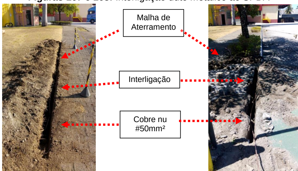
Figuras 169 e 170: Interligação malha aterramento do Castelo de Água c/ Armazém Vertical
