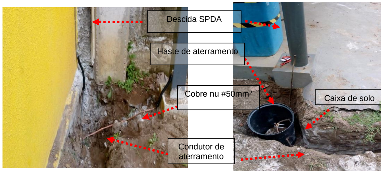
Figuras 17 e 18: Malha de Aterramento do Setor Jardinagem
