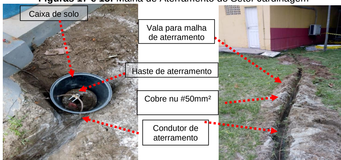
Figuras 19: Caixa de inspeção de solo // Figura 20: Interligação Malha de Aterramento
