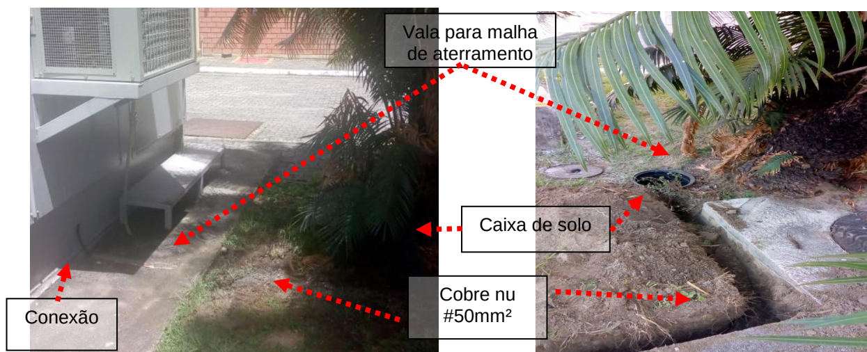
Figuras 77 e 78: Conexão da estrutura do Eletrocentro com a Malha de Aterramento Interligação entre os subsistemas de aterramento do Eletrocentro-SE e Armazém 04
