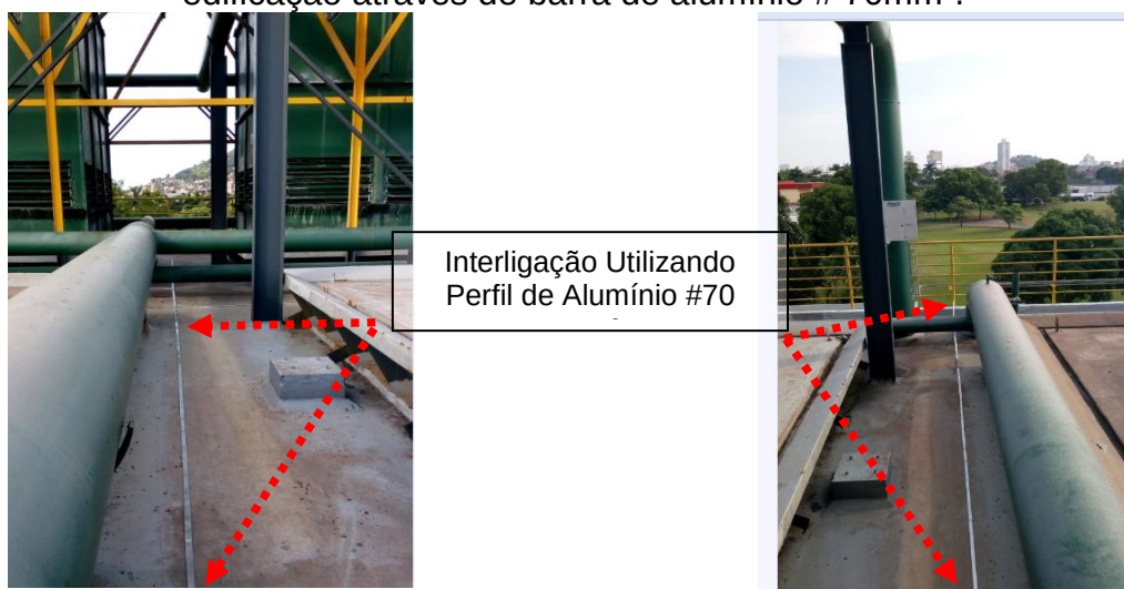
Figuras 45 e 46: Malha captora instalada na laje de cobertura da edificação através de barra de alumínio #70mm².
