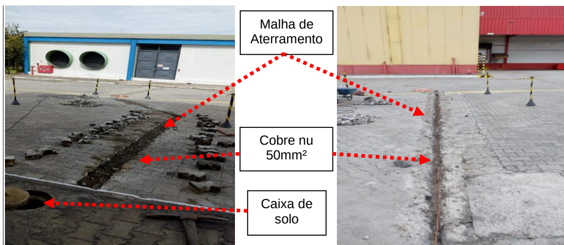
Figuras 208 e 209: Interligação entre o Armazém Vertical e a Central de Água Gelada
