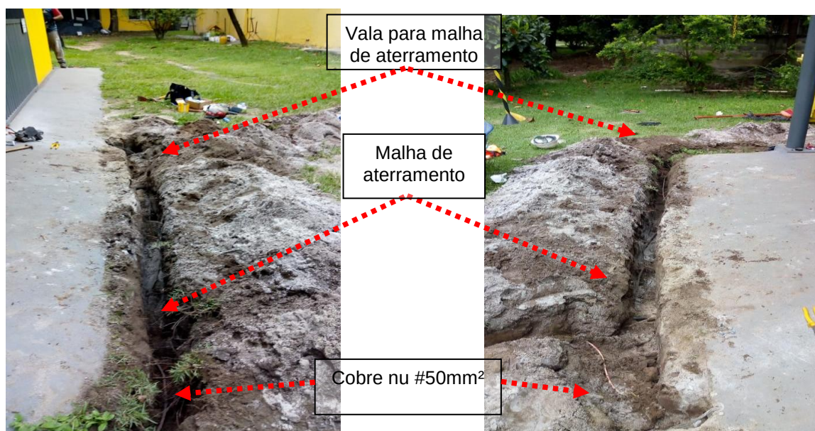
Figuras 15 e 16: Malha de Aterramento do Setor Jardinagem
