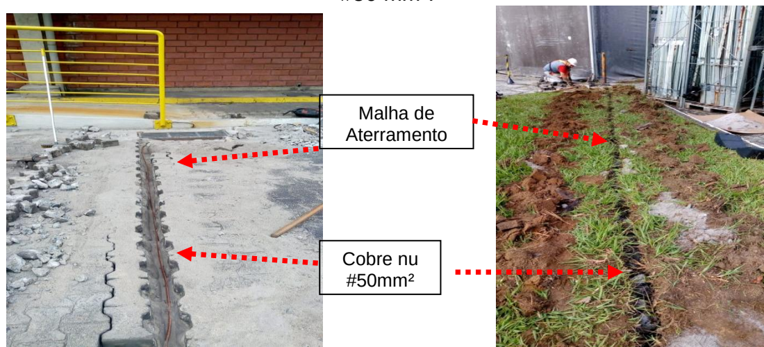
Figuras 144 e 145: Interligação da malha do Armazém 04 com a do Galpão de Lona
