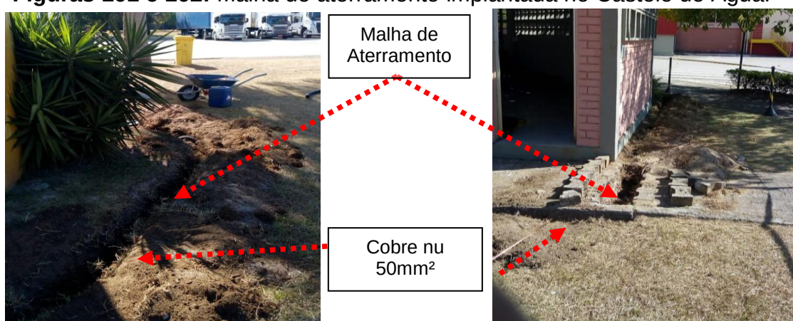
Figuras 163 e 164: Malha de aterramento implantada no Castelo de Água.
