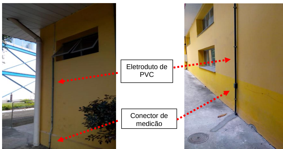
Figuras 32 e 33: Descida do SPDA em perfil de alumínio #70mm 2 .
