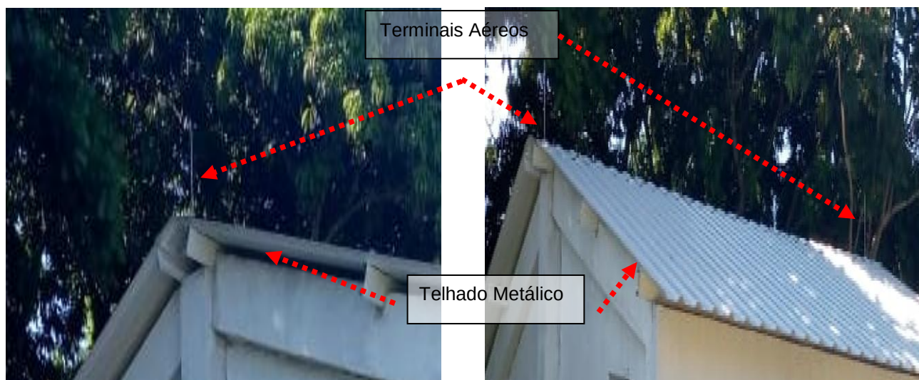
Figuras 03 e 04: Terminais aéreos instalados sobre telhado metálico na Sala de Materiais - Manutenção
