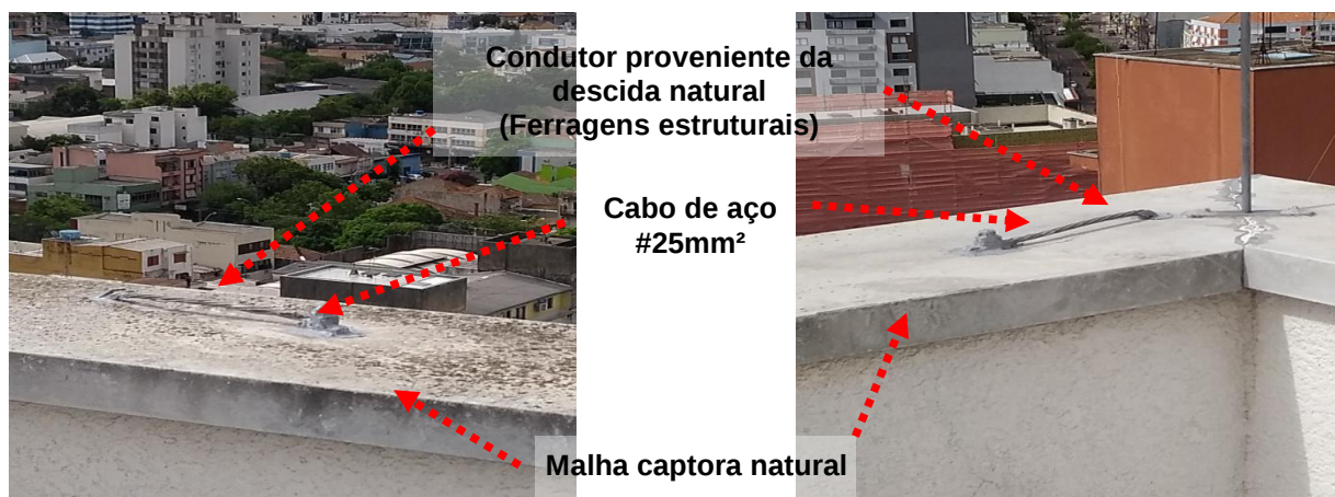
Figuras 48 e 49: Interligações entre as descidas naturais em cabo de aço com a malha captora
