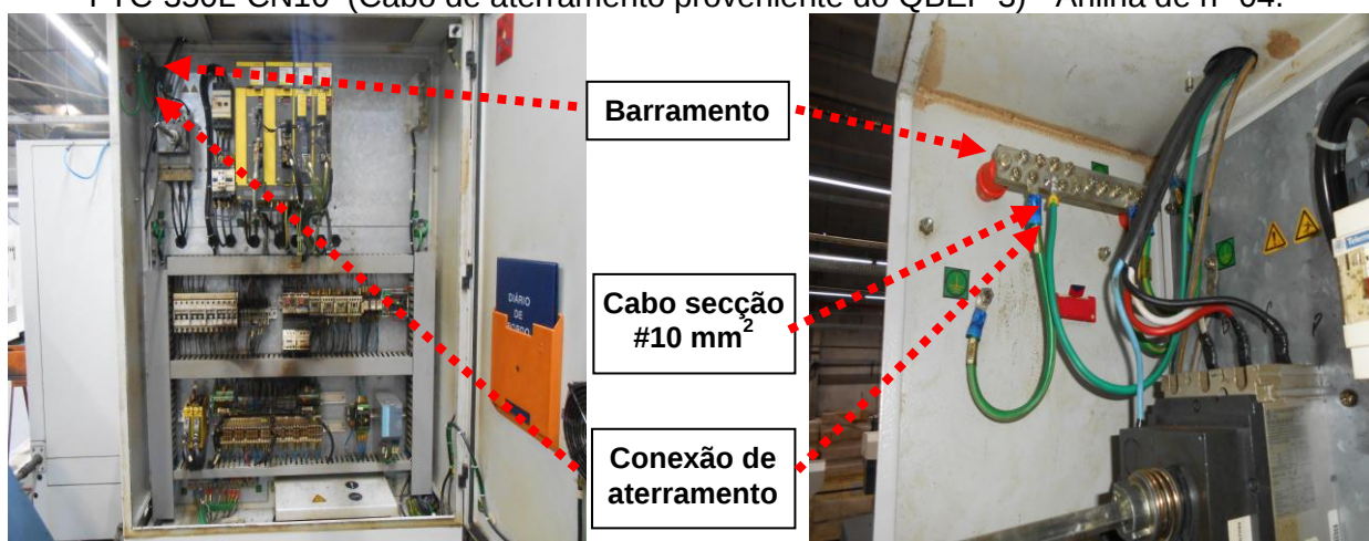
Figuras 56 e 57: Ponto de aterramento do barramento do painel junto a Máquina ROMI DISCOVERY 760-CN02 (Cabo de aterramento proveniente do QBEP 3) - Anilha de nº 07.
