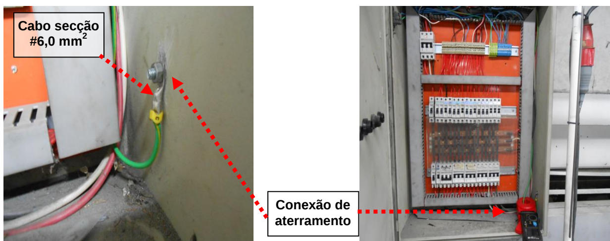
Figuras 67 e 68: Ponto de aterramento no painel na Área de Montagem (Cabo de aterramento proveniente do QBEP 2) - Anilha de nº 03.
