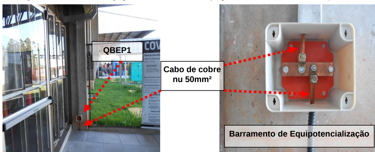
Figuras 03 e 04: Barramento de Equipotencialização (QBEP-0).
