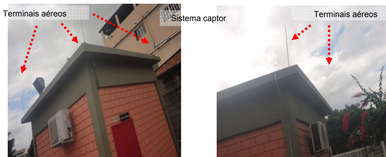
Figuras 120 e 121: Sistema captor existente na área da Central de Telefonia
