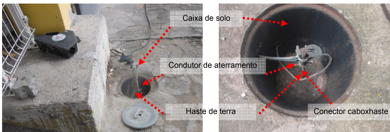
Figuras 32 e 33: Sistema Aterramento — Sala de Materiais – Engenharia -Caixa de solo
