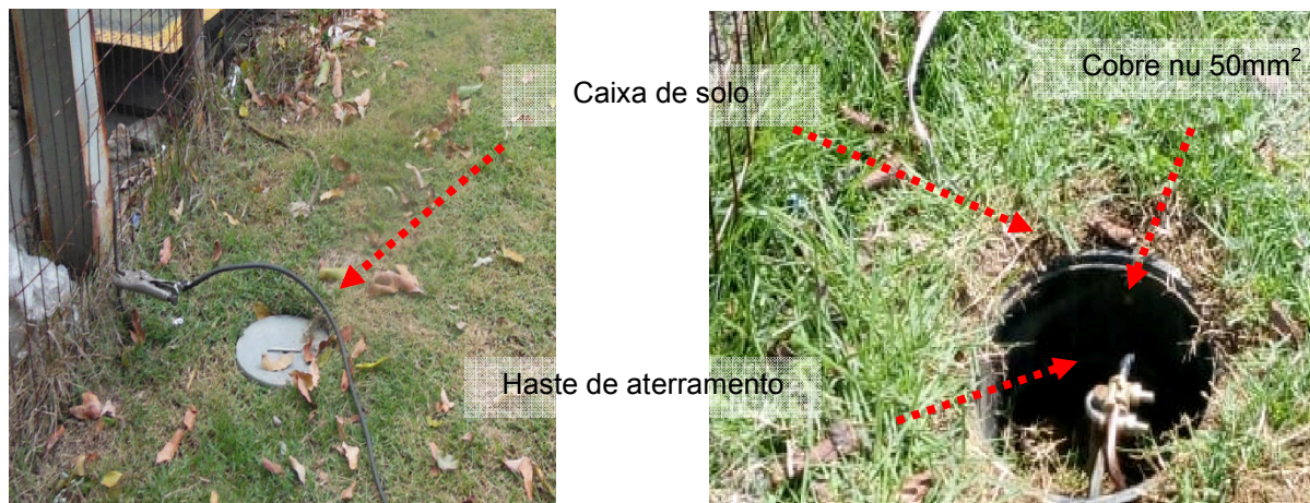
Figuras 97 e 98: Armazém de Material 02 - Sistema de aterramento – Caixa de solo
