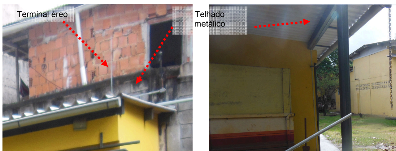
Figuras 08 e 09: Sistema captor existente no setor de jardinagem.
