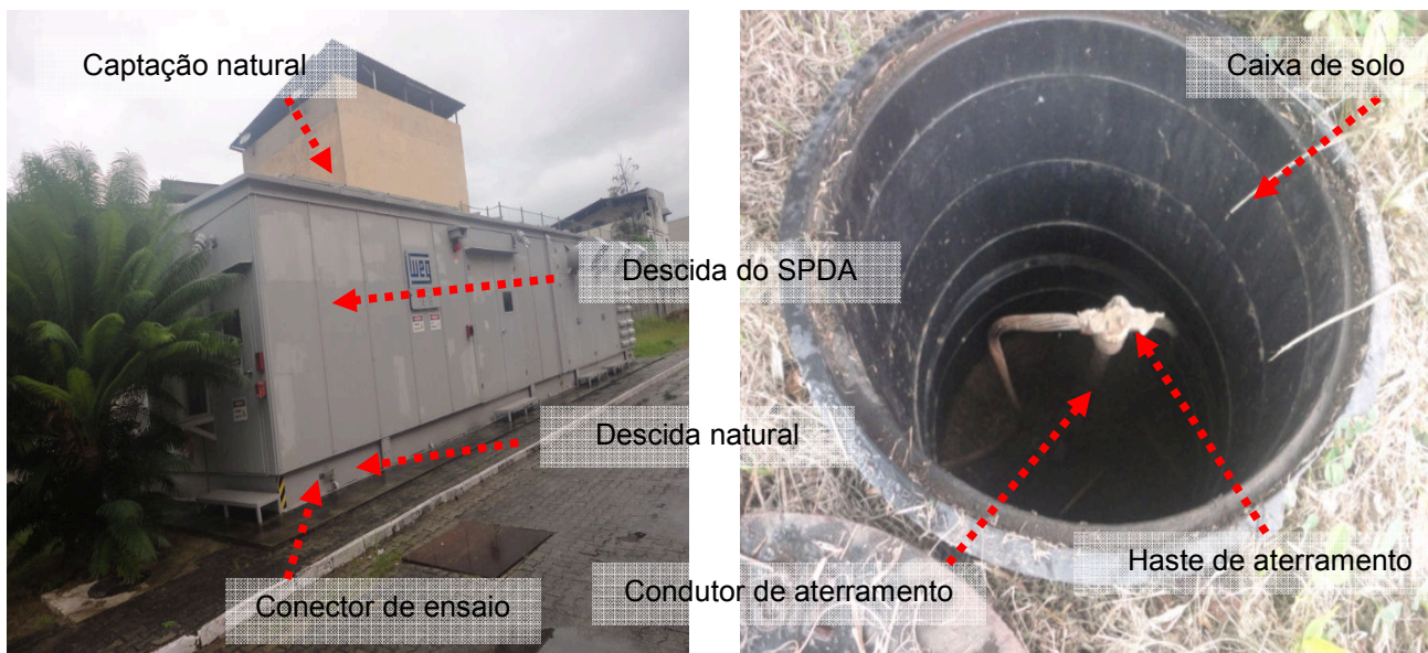
Figuras 115 e 116: Sistema existentes - Eletrocentro – SE
