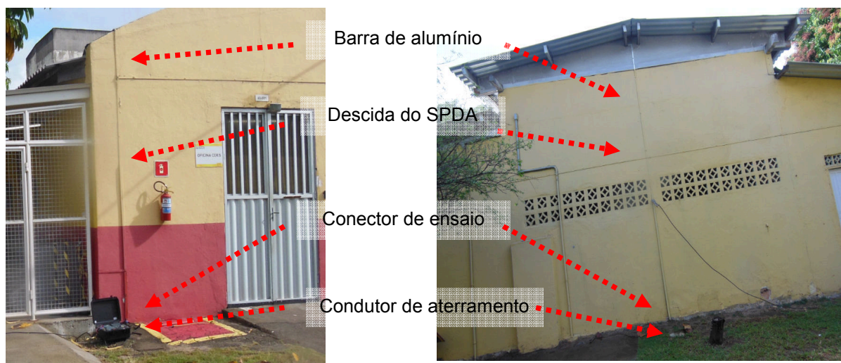
Figuras 17 e 18: Sistema de descidas convencionais - Oficina de Manutenção / Arquivo
