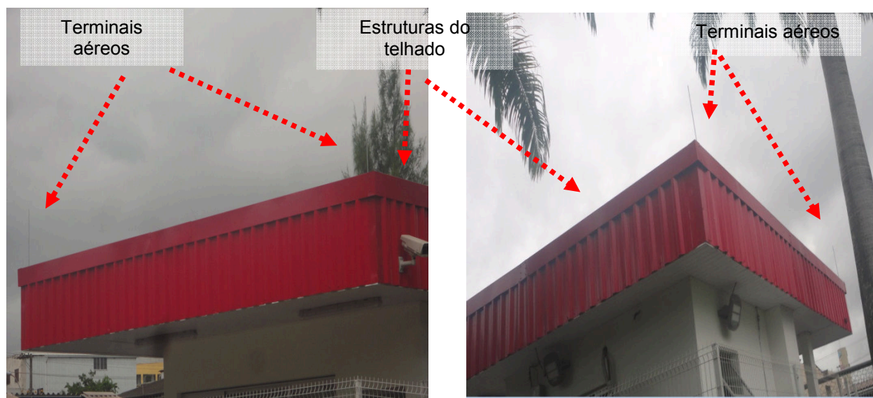
Figuras 67 e 68: Sistema captor existente na Portaria 02
