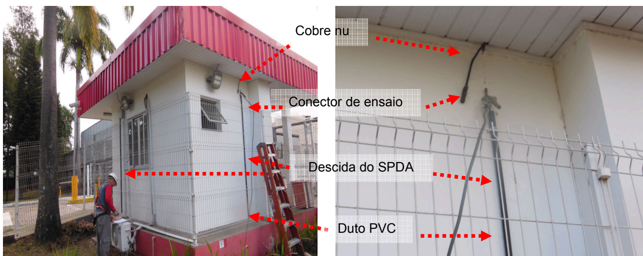
Figuras 69 e 70: Sistema de descidas convencionais na Portaria 02
