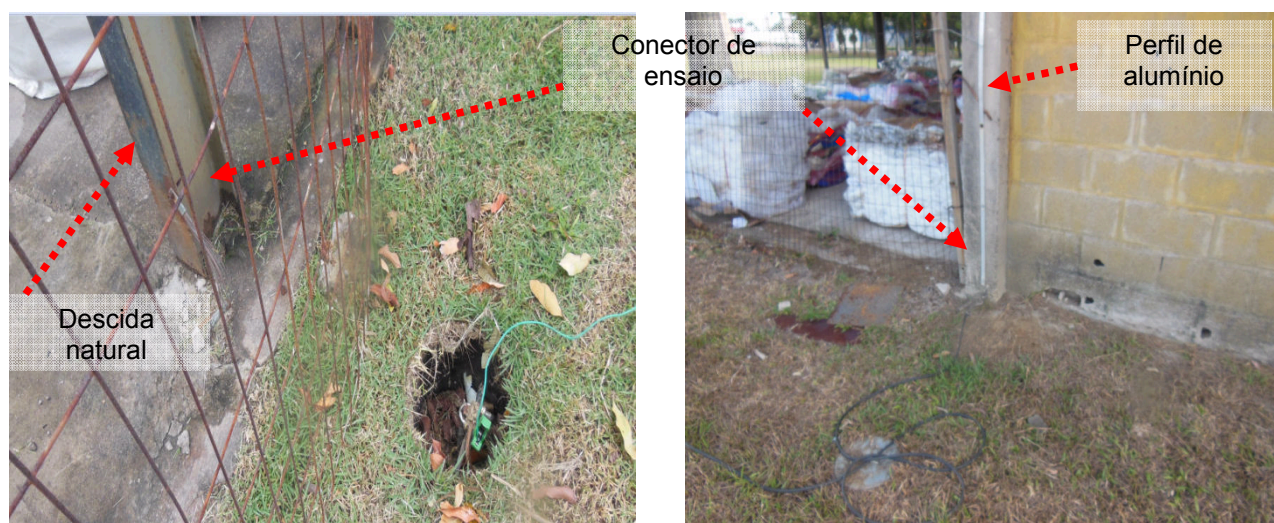
Figuras 88 e 89: Sistema de descida existente no Armazém de Material I.
