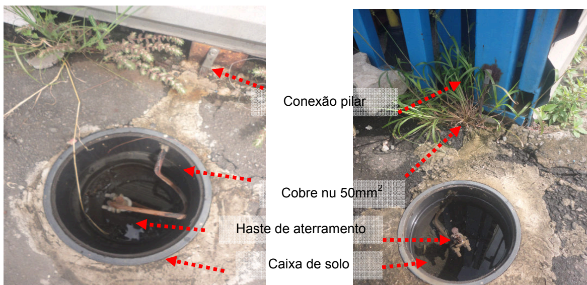
Figuras 83 e 84: Canteiro de obra 02 - Sistema de aterramento – Caixa de solo
