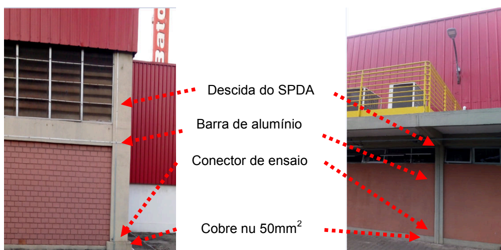
Figuras 185 e 186: Sistema de descidas existentes no armazém 04.
