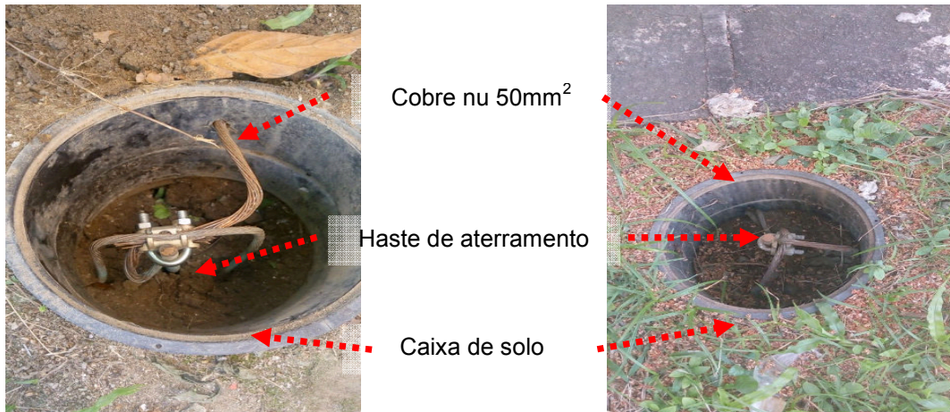
Figuras 257 e 258: Centro de Conveniência – Sist. de aterramento – Caixa de solo
