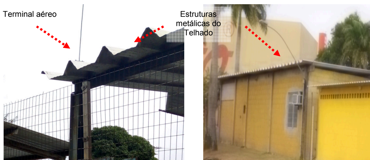
Figuras 86 e 87: Sistema captor existente no Armazém de Materiais I
