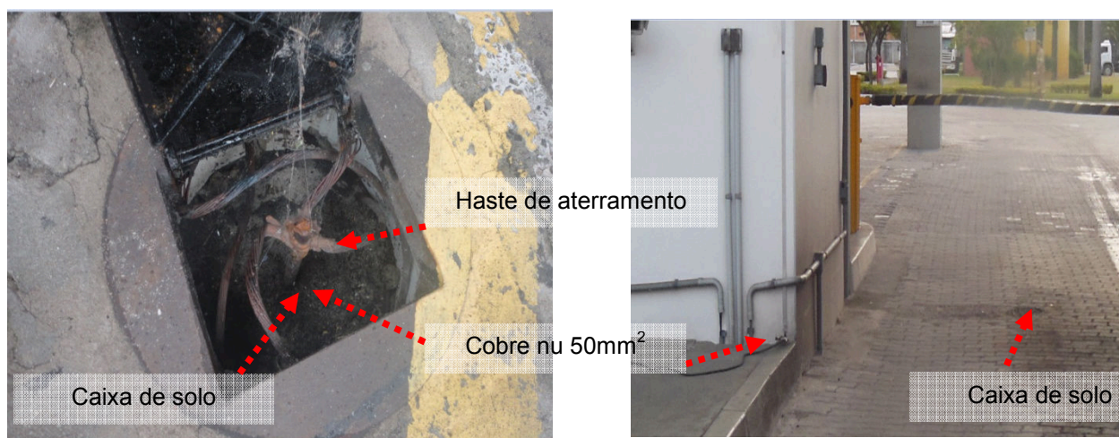
Figuras 143 e 144: Portaria 01 – Sist. de aterramento – Caixa de solo
