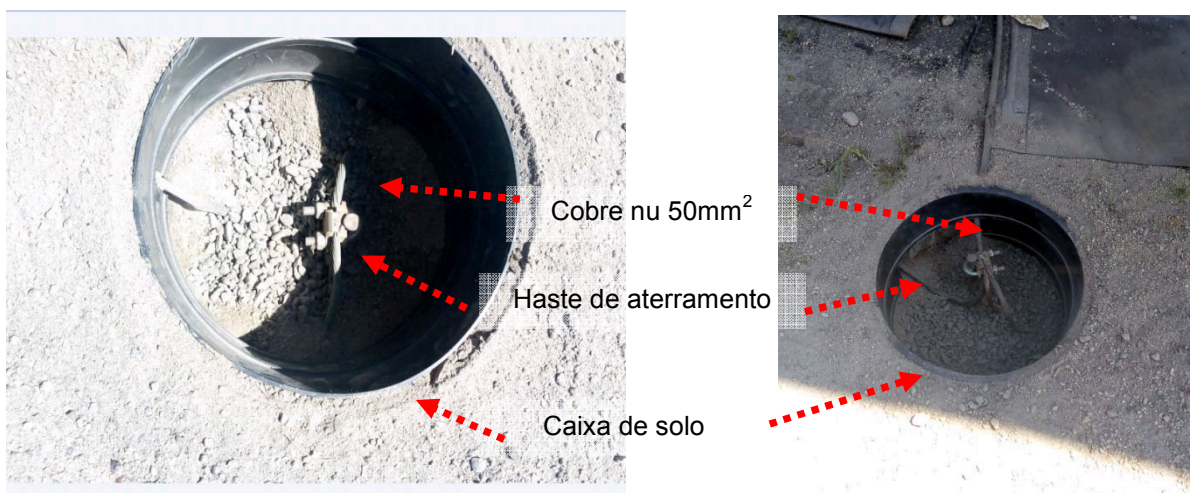
Figuras 242 e 243: Galpão de Lona – Sist. de aterramento – Caixa de solo
