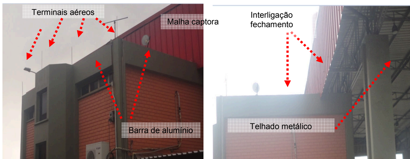
Figuras 135 e 136: Sistema captor existente na Portaria 01.
