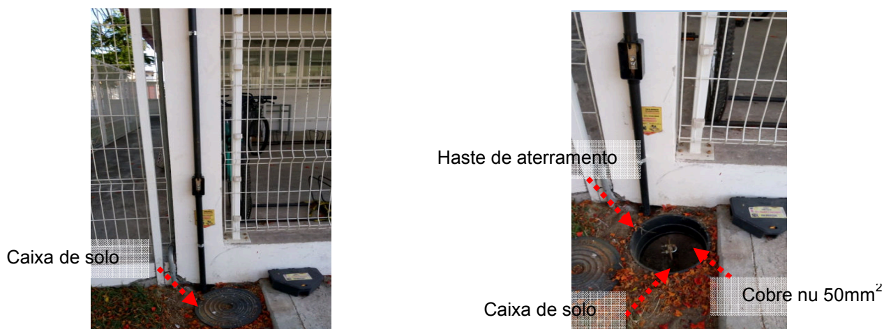
Figuras 156 e 157: Anexo da Portaria 01 – Sist. de aterramento – Caixa de solo
