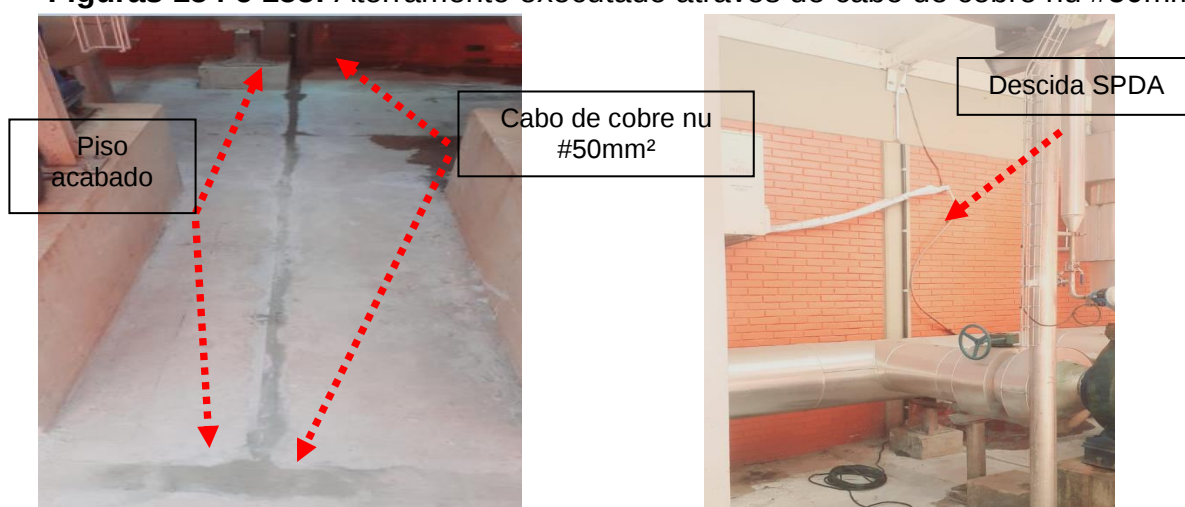
Figuras 156 e 157: Aterramento executado através de cabo de cobre nu #50mm 2 .
