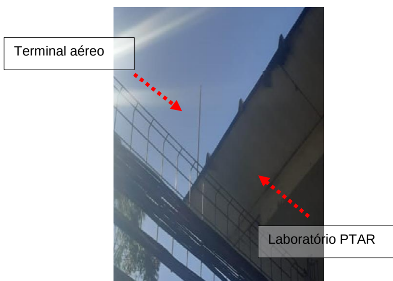
Figura 294: Fixação adequada de um dos terminais aéreos na cobertura do prédio do laboratório do PTAR.
