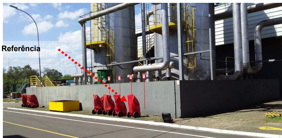
Figuras 476: Referência – Utilidades – Prédio 28.
