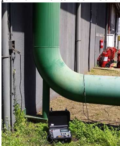
Figuras 455: Referência – Utilidades – Prédio 28.
