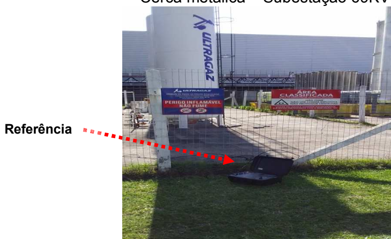
Figuras 662: Condutor de Aterramento – Abastecimento GLP Prédio 27
