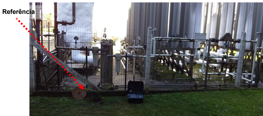
Figuras 669: Conductor de Aterramento – Estoque de Químicos e Inflamáveis – Prédio 24.
