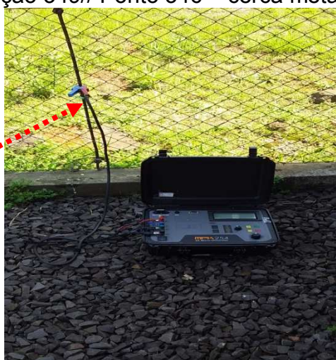
Figuras 639: Condutor de Aterramento – Cerca Metálica – Subestação 69KV
