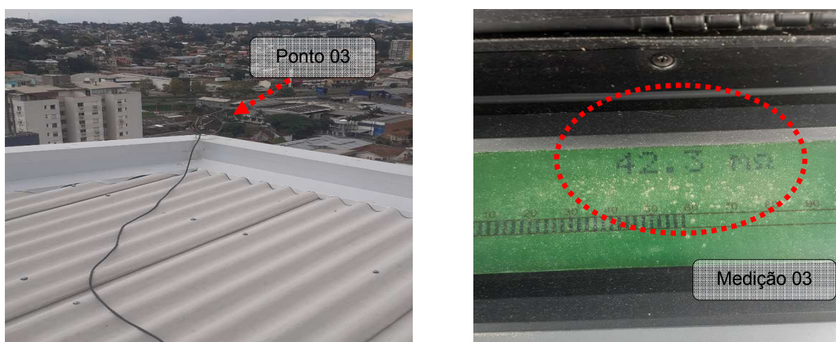
Figuras 11 e 12: Ponto 03 - Medição na cobertura – Descida 03A do SPDA.
