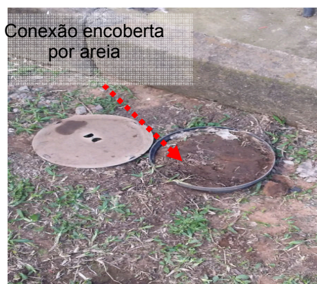
Figura 53: Caixa de inspeção – Conexão cabo x haste encoberta
