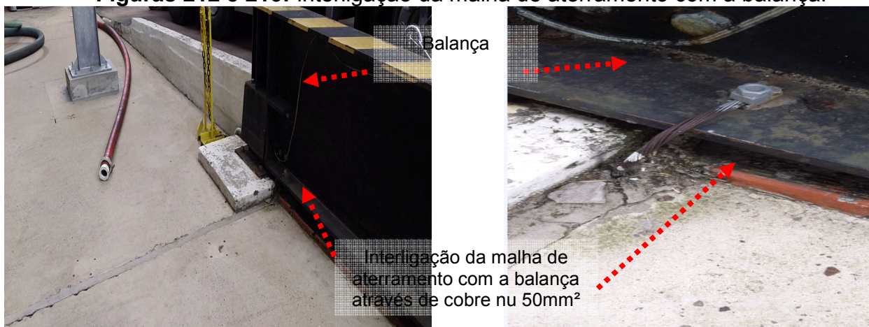
Figuras 214 e 215: Interligação da malha de aterramento com a balança.
