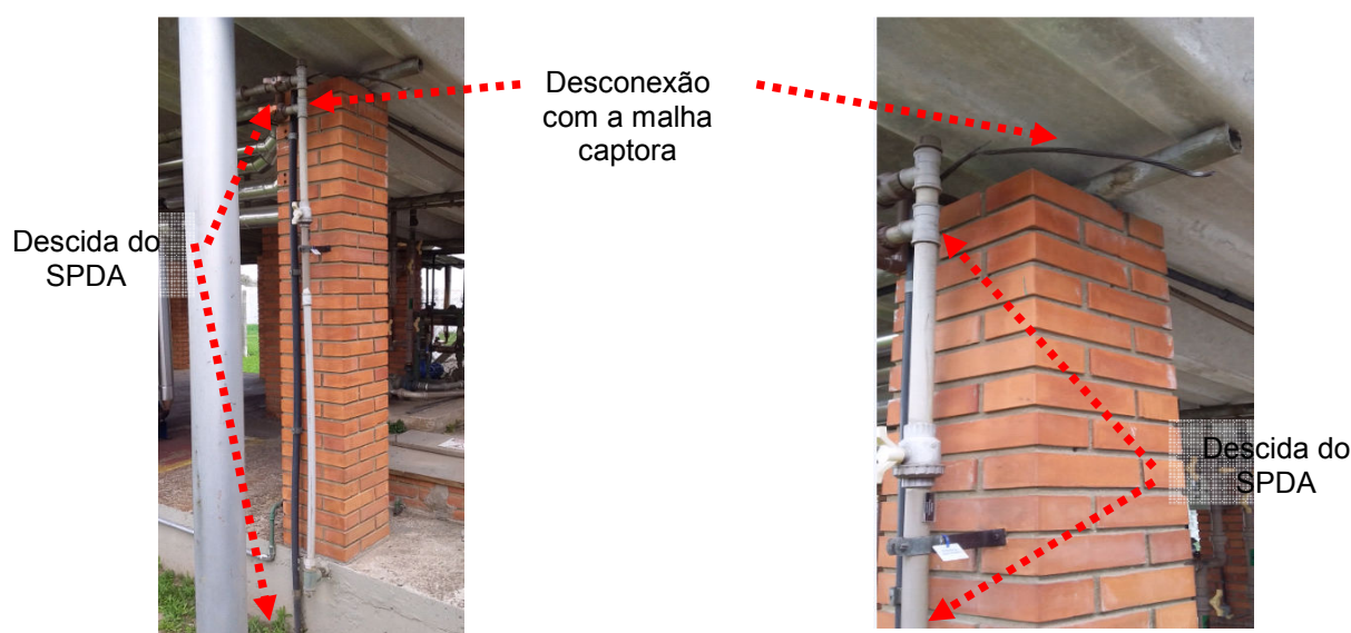
Figuras 244 e 245: Sistema de descida – Cisterna – Desconexão com a malha captora
