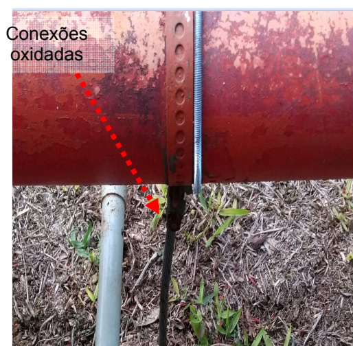
Figura 146: Conexões Oxidadas – ADM / Expedição / Manutenção /LCQ.
