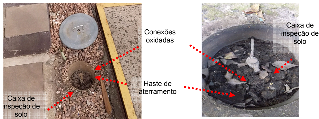
Figuras 273 e 274: Sistema de Aterramento– Ribeira Sólida/Refeit/Vest/Guarita/Recep.
