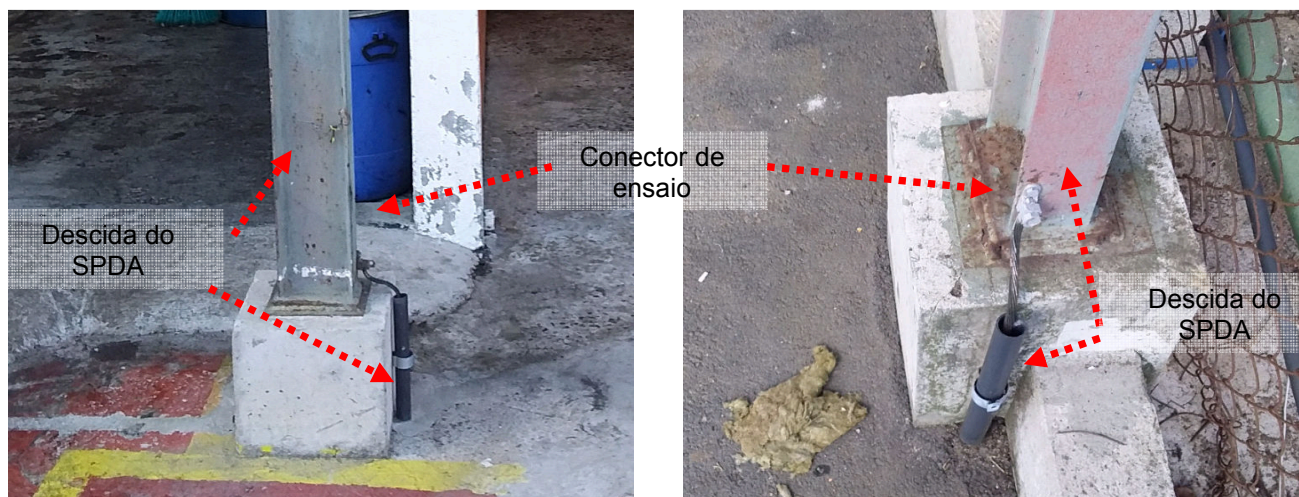
Figuras 47 e 48: Sistema de Descidas - Telheiro.
