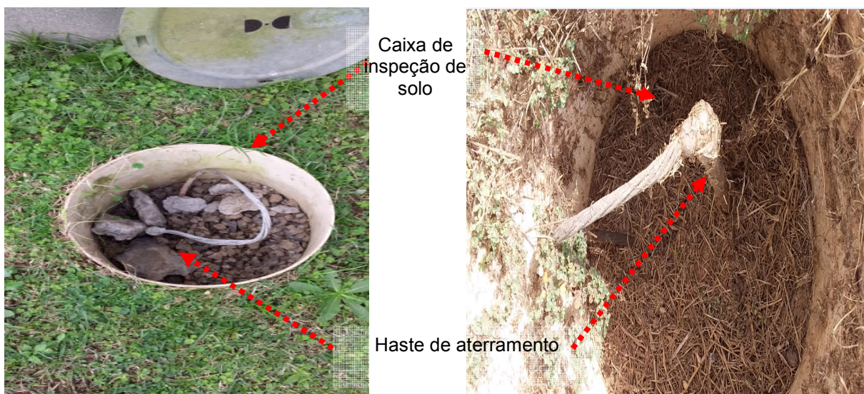
Figuras 291 e 292: Sistema de Aterramento – Caixas de inspeção de solo – CDTC.
