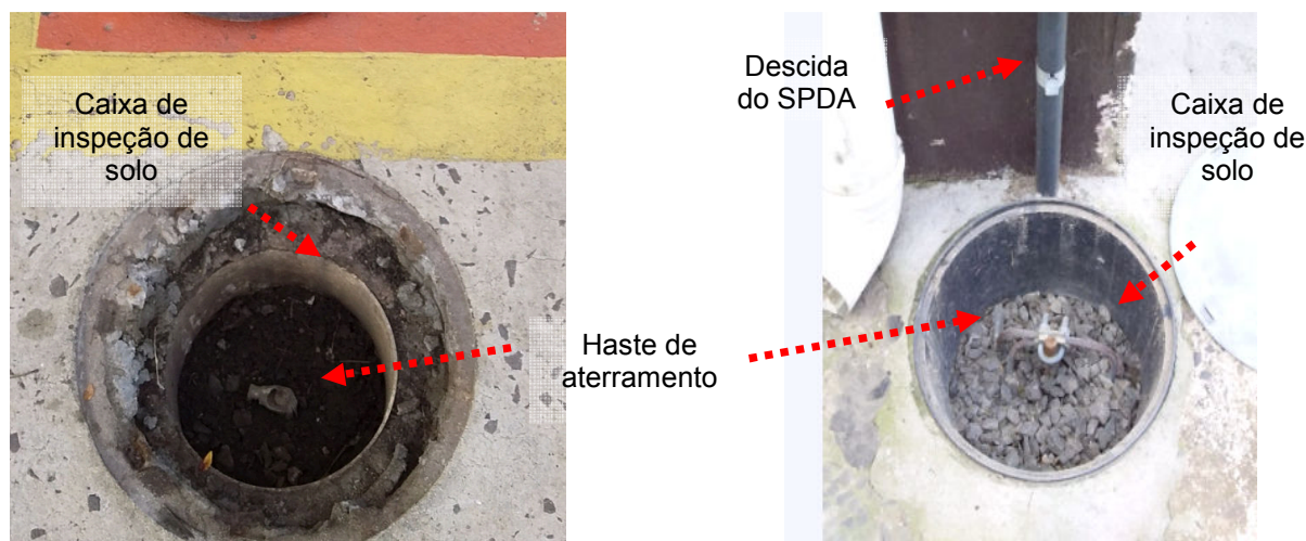
Figuras 267 e 268: Sistema de Aterramento– Ribeira Sólida/Refeit/Vest/Guarita/Recep.
