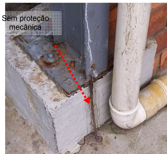
Figura 153: Sistema de Descidas – Ribeira Líquida – Sem proteção mecânica
