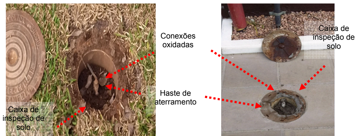
Figuras 271 e 272: Sistema de Aterramento– Ribeira Sólida/Refeit/Vest/Guarita/Recep.
