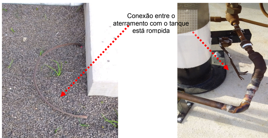
Figuras 117 e 118: Conexão da malha de aterramento com o tanque de nitrogênio rompida.
