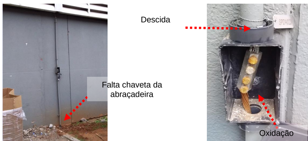
Figuras 15 e 16: Descidas - Não conformidades
