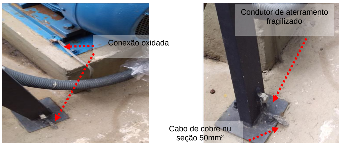
Figuras 74 e 75: Conexão oxidada / Cabo de aterramento fragilizado.
