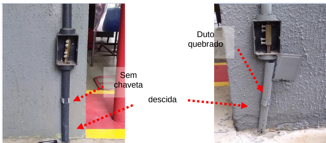
Figuras 104 e 105: Subsistema de descidas – Não conformidades
