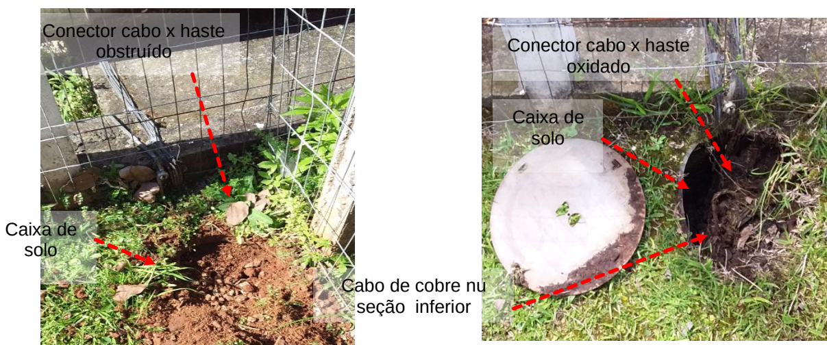
Figuras 855 e 856: Conector cabo x haste obstruído /// oxidado /// Condutor de aterramento com secção inferior ao estipulado pela norma
