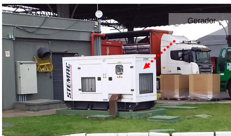
Figura 152: Elemento metálico não interligado ao SPDA
