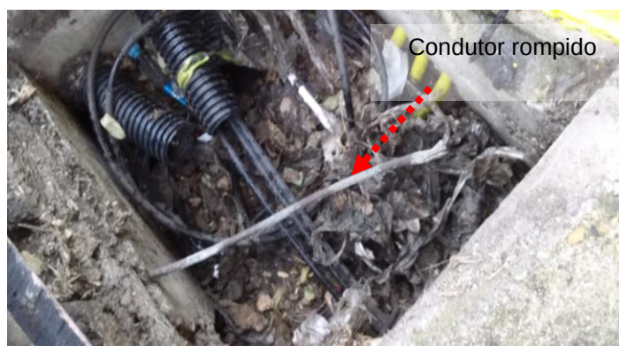
Figura 149: Condutor de aterramento rompido
