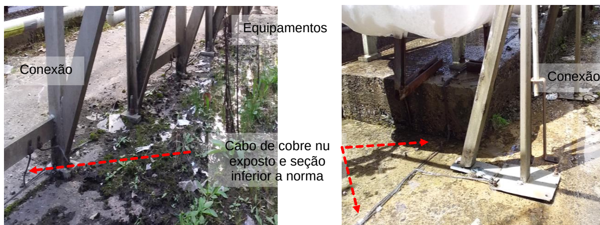
Figuras 845 e 846: Subsistema de aterramento - Prédio 27 – Abastecimento de GLP
