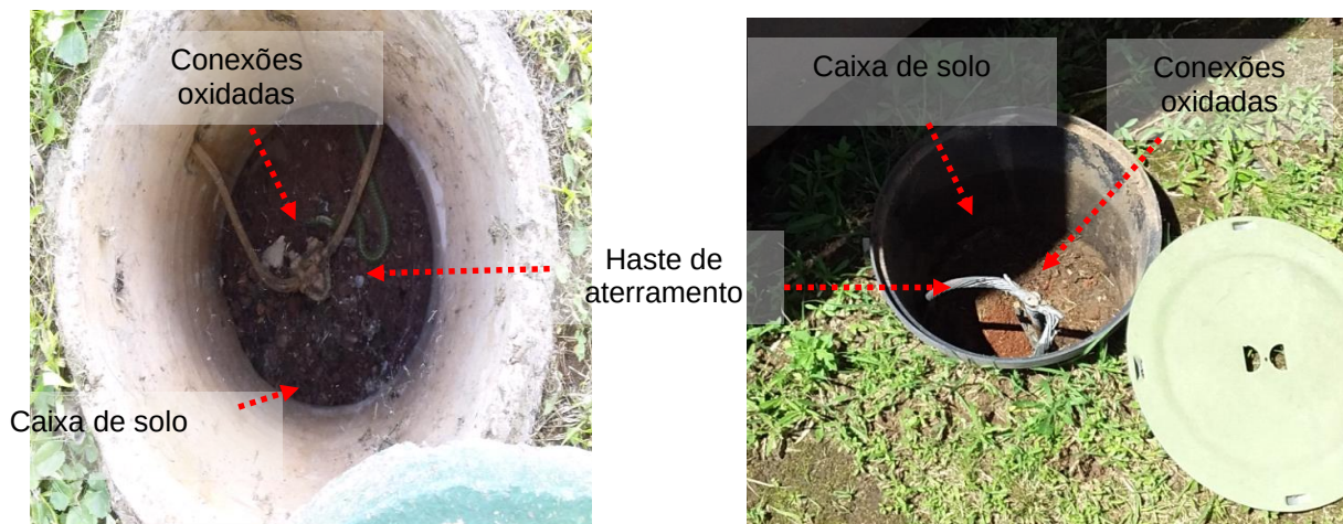
Figuras 433 e 434: Subsistema de aterramento – Não conformidades
