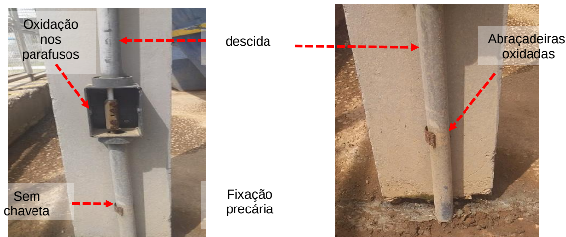
Figuras 513 e 514: Subsistema de descidas – Não Conformidades
