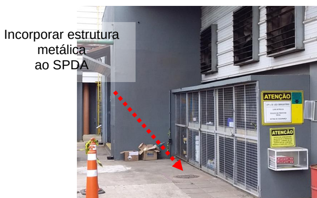
Figura 129: Elemento metálico não interligado ao SPDA
