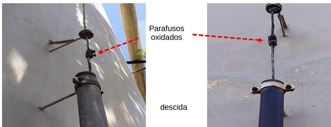
Figuras 796 e 797: Subsistema de descidas – Não conformidades encontradas
