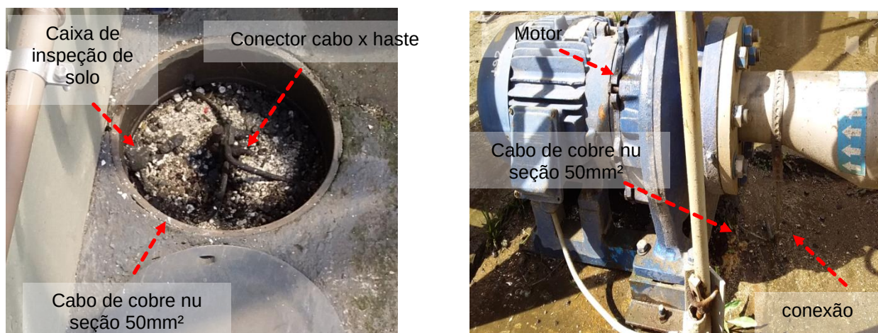
Figuras 770 e 771: Caixa de inspeção de solo //// Interligação entre elementos metálicos e a malha de aterramento.
