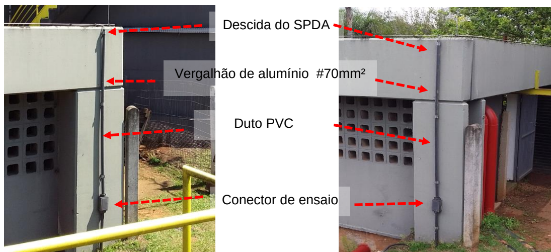
Figuras 663 e 664: Sistema de Descidas convencionais – Vergalhão de alumínio
