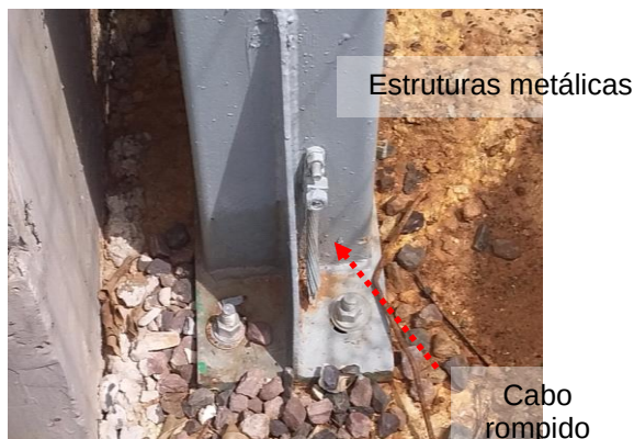
Figura 388: Indicação do rompimento entre a malha de aterramento e a estrutura.
