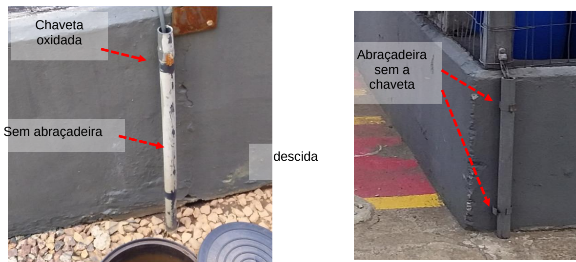
Figuras 489 e 490: Subsistema de descidas - Não conformidades
