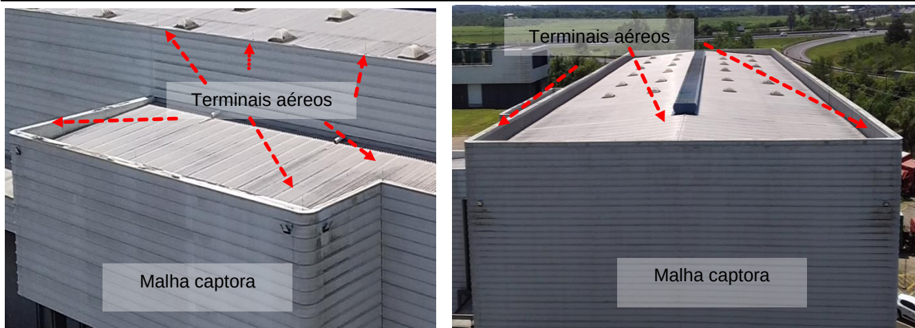
Figuras 439 e 440: sistema captor existente – Prédio 21 -Depósito de Equipamentos
