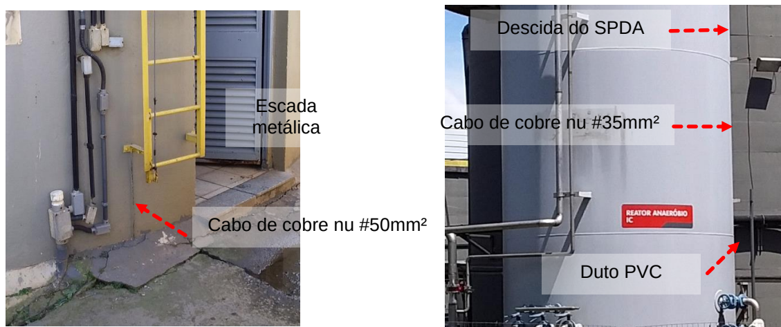
Figuras 762 e 763 : Sistema de Descidas Naturais – Escada de acesso Sistema de Descidas convencionais – Cabo de cobre nu #35mm²
