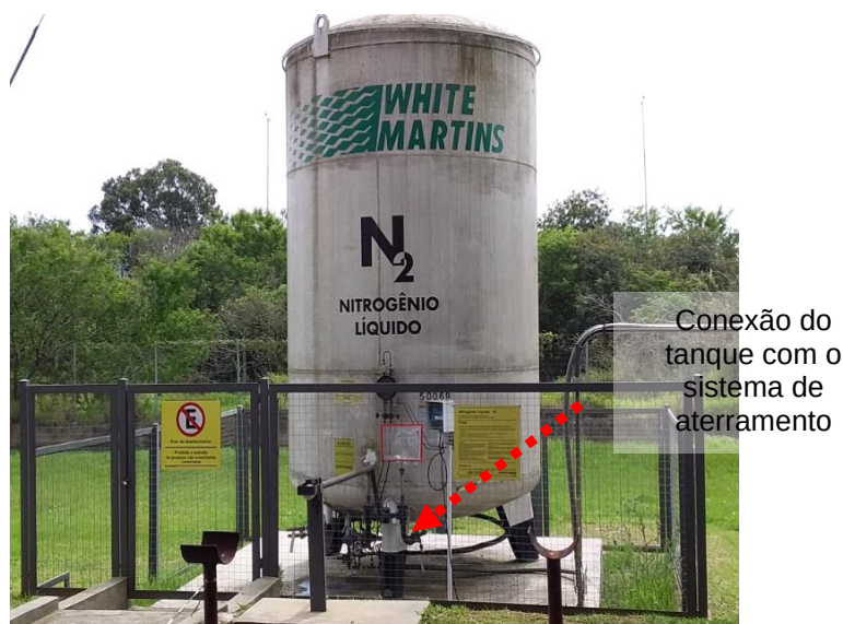
Figura 37: Cabo de aterramento do tanque de N2 inferior ao estipulado pela norma.
