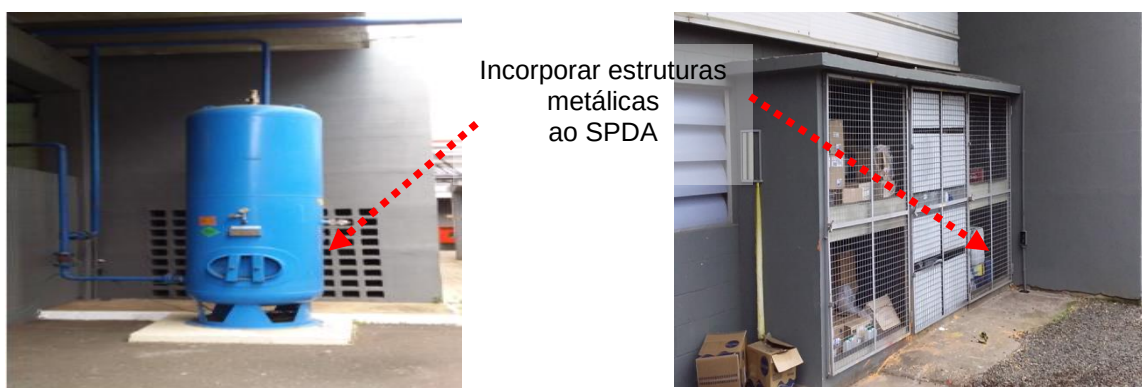
Figuras 127 e 128: Elementos metálicos não interligados ao SPDA
