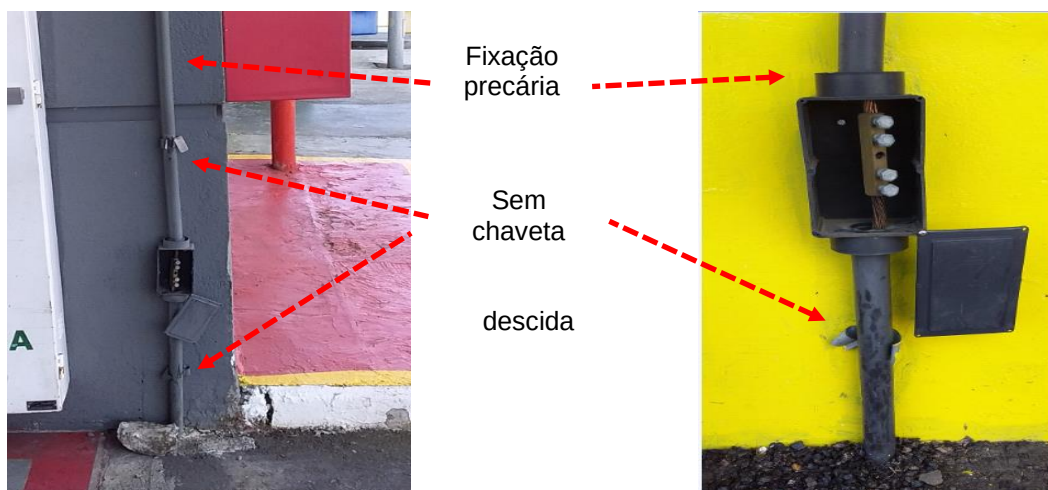
Figuras 174 e 175: Descidas – Não conformidades
