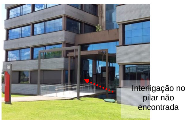
Figura 423: Interligação projetada entre elemento metálico e a malha de aterramento não foi encontrada
