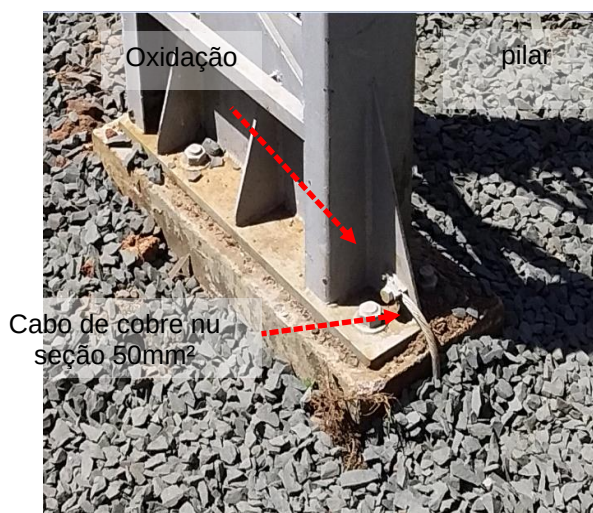
Figura 317: Oxidação na conexão entre ponto da malha de aterramento e a estrutura.
