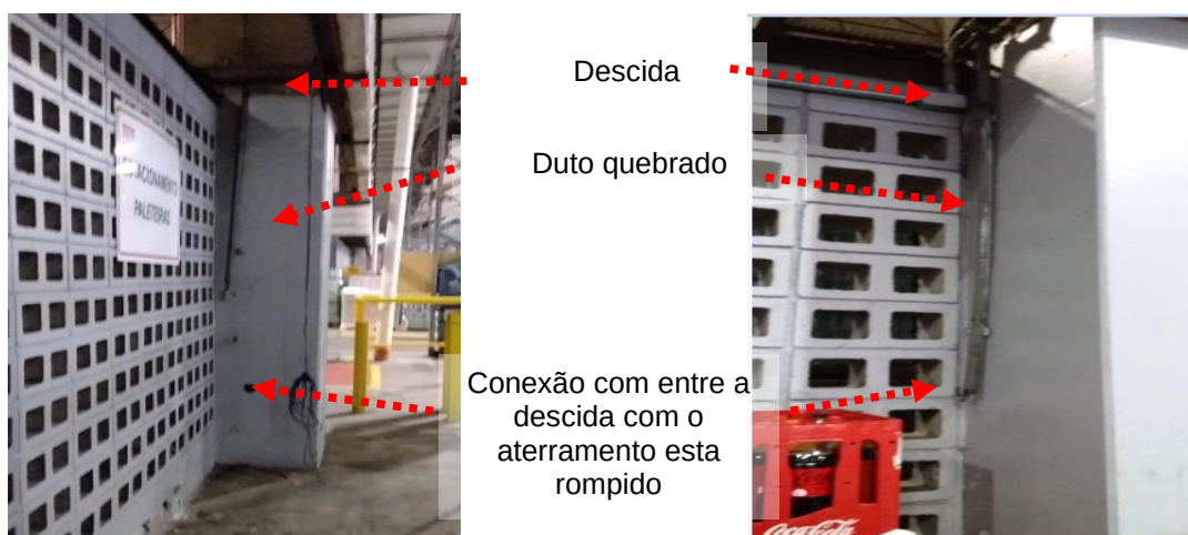
Figuras 35 e 36: Descidas - Não conformidades
