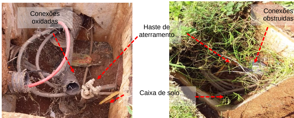
Figuras 682 e 683: Subsistema de aterramento – Não conformidades
