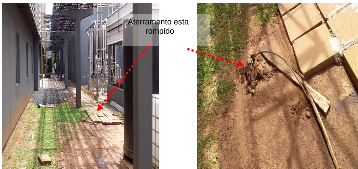
Figuras 38 e 39: Aterramento - Não conformidades
