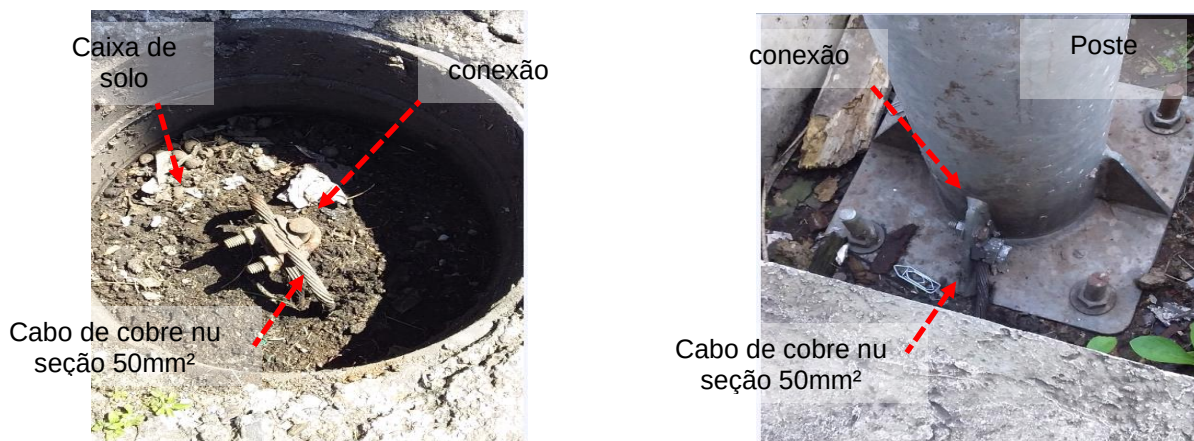
Figuras 168 e 169: Caixa de solo //Interligação entre elementos metálicos e a malha de aterramento.
