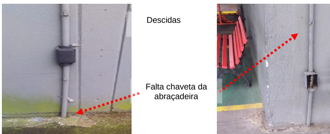
Figuras 13 e 14: Descidas - Não conformidades
