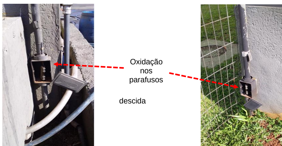
Figuras 209 e 210: Subsistema de descidas – Não conformidades
