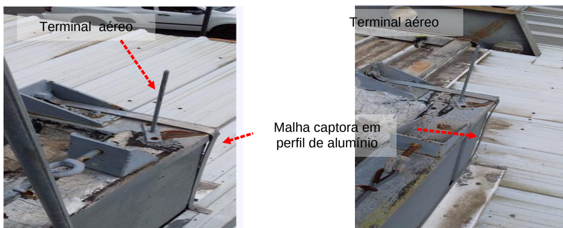
Figuras 323 e 324: Sistema captor existente – Prédio 13 –SEMT/Banco
