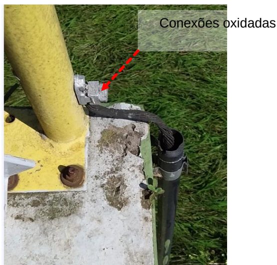
Figura 899: Sistema de descidas – Não conformidades
