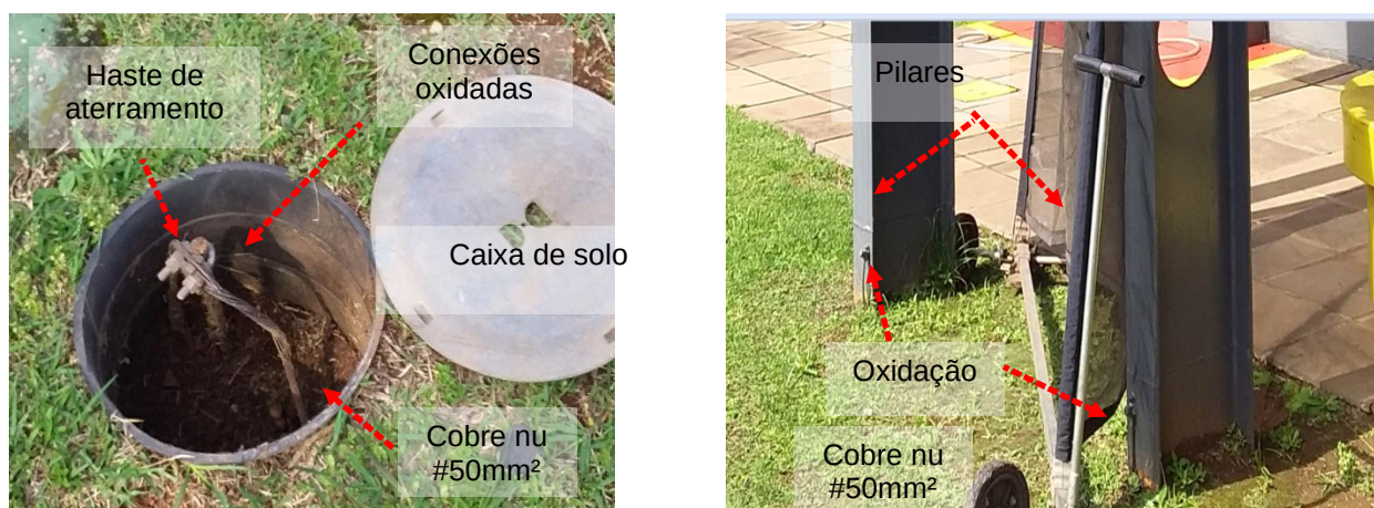
Figuras 349 e 350: Subsistema de aterramento – Não conformidades
