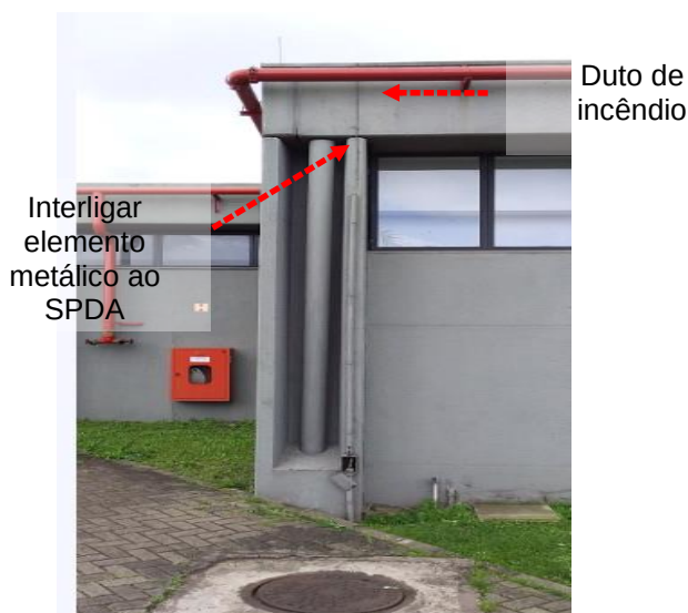
Figura 269: Elemento metálico não interligado ao SPDA
