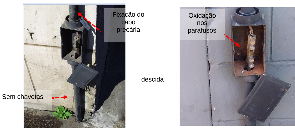
Figuras 207 e 208: Subsistema de descidas – Não conformidades
