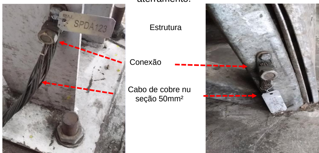
Figuras 170 e 171: Interligação entre elementos metálicos e a malha de aterramento.
