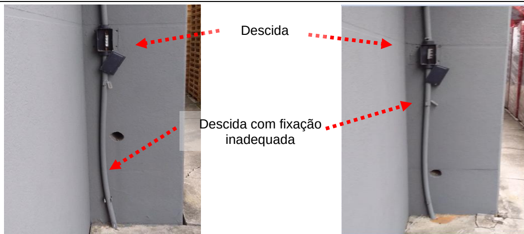
Figuras 29 e 30: Descidas - Não conformidades
