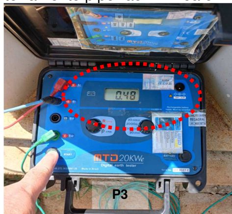
Figura 198: Valores das medições em (P3). Aterramento pipe-rack – Área chiller
