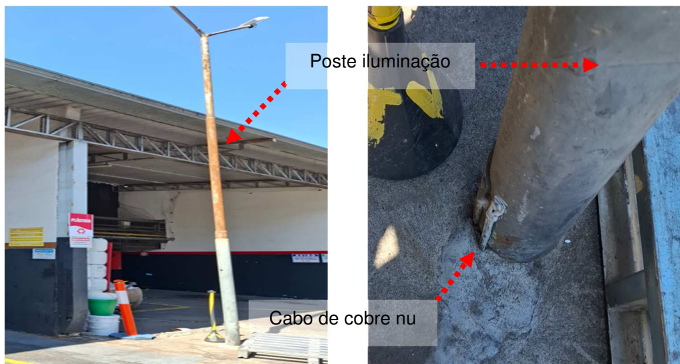
Figuras 295 e 296: Conexões entre a malha de terra com poste de iluminação.
