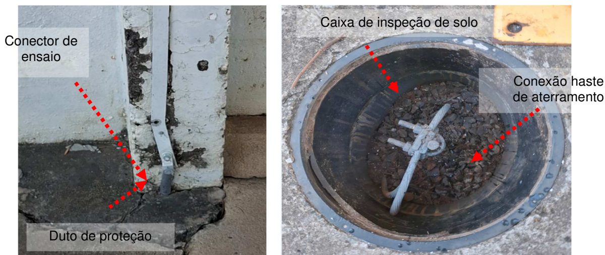
Figuras 15 e 16: Sistema de aterramento.
