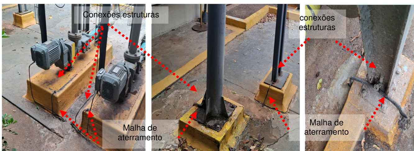
Figuras 69,70 e 71: Conexões malha de terra com as estruturas metálicas no entorno.
