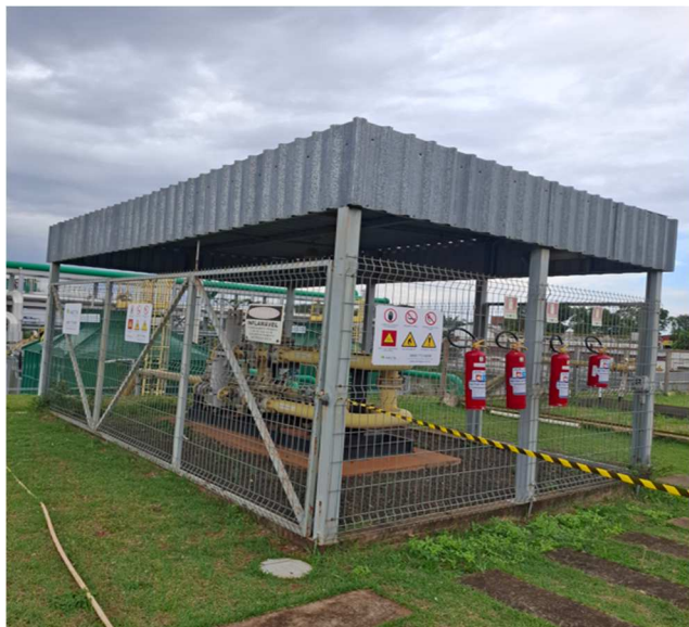
Figura 260: Estação de gás natural
