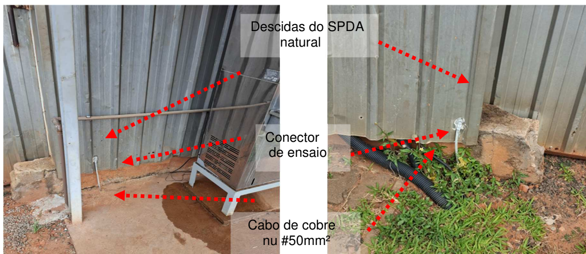
Figuras 607 e 608: Sistema de descidas do tipo natural existente nos galpões novos.
