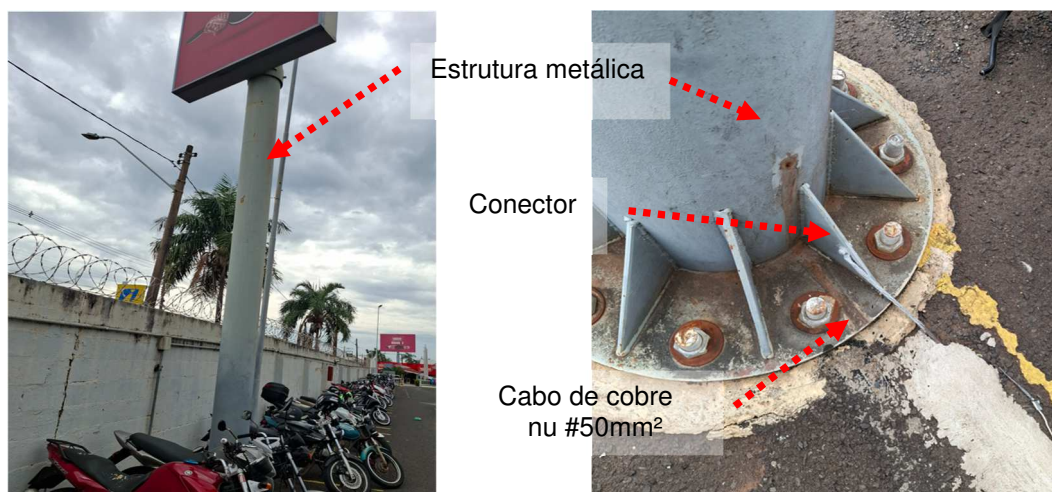
Figuras 673 e 674: Sistema de aterramento existente /Conexões estruturas.
