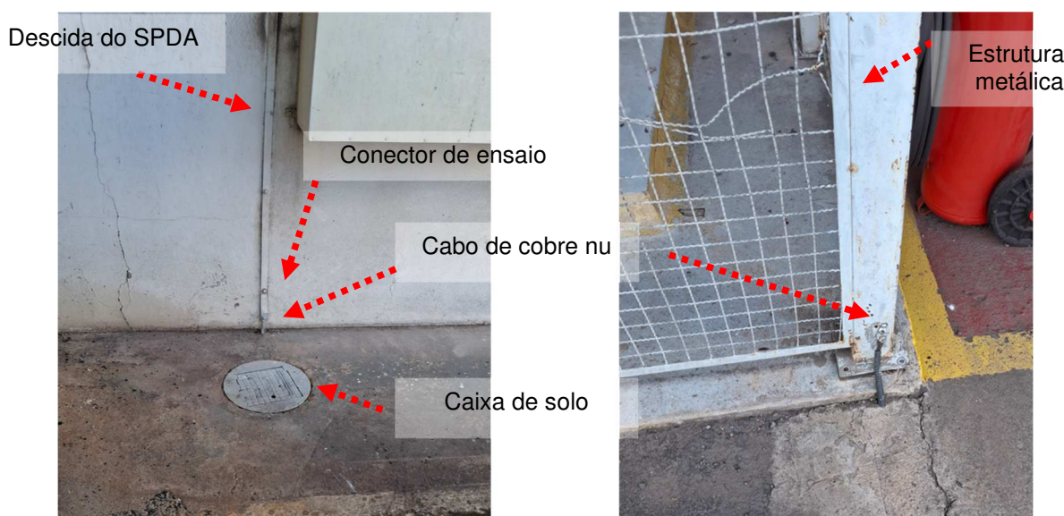
Figuras 132 e 133: Conexão entre malha de terra descida do SPDA e estrutura.
