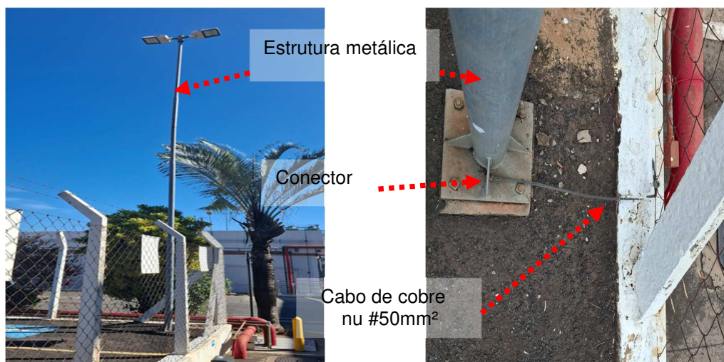
Figuras 677 e 678: Sistema de aterramento existente / Conexões estruturas.
