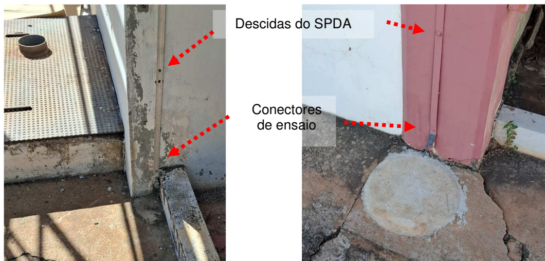
Figuras 28 e 29: Sistema de aterramento.
