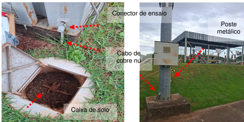
Figuras 271 e 272: Conexões entre a malha de terra e a haste no interior da cx. de solo.
