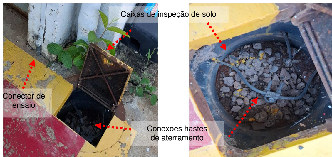
Figuras 13 e 14: Sistema de aterramento.
