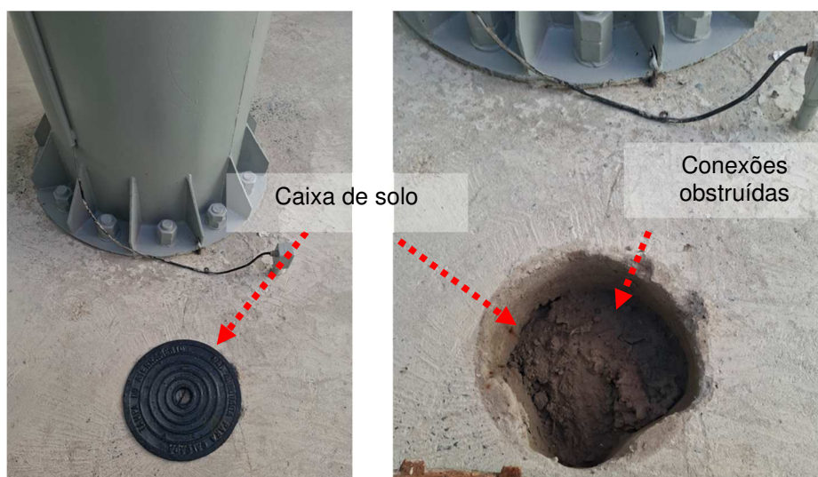
Figuras 214 e 215: Caixa de solo -Conexões obstruídas
