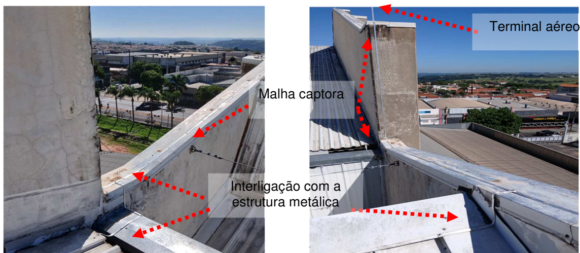
Figuras 490 e 491: Malha captora em perfil de alumínio secção #70mm².
