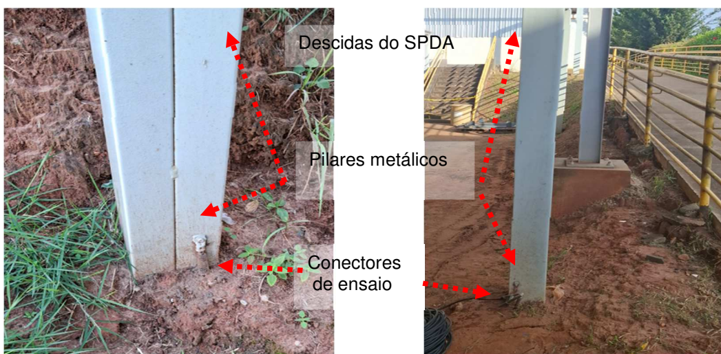
Figuras 252 e 253: Sistema de descidas existentes naturais.
