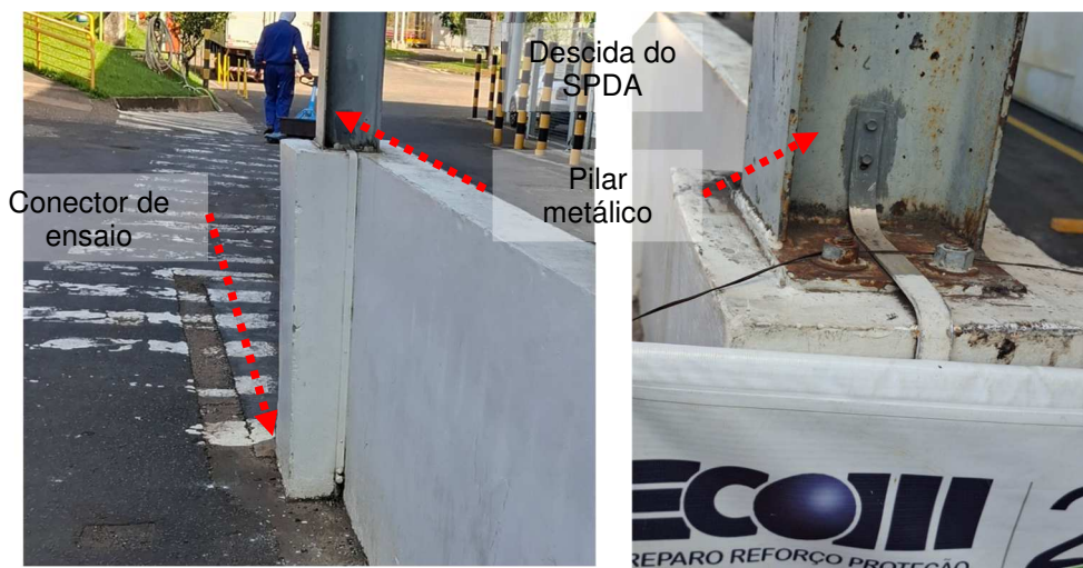
Figuras 130 e 131: Descidas naturais do SPDA -Pilares metálicos
