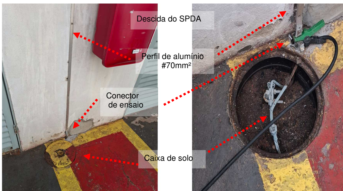
Figuras 235 e 236: Sistema de aterramento existente.
