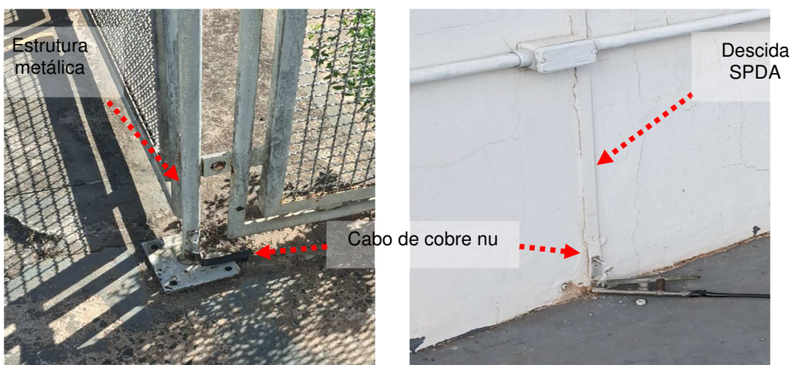
Figuras 362 e 363: Conexões entre a malha de terra e estrutura e a descida do SPDA .
