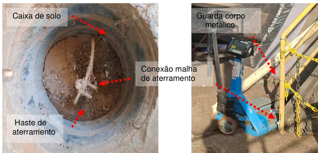
Figuras 254 e 255: Sistema de aterramento.
