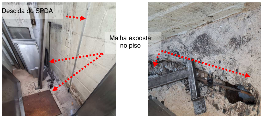
Figuras 258 e 259: Malha de aterramento exposta no piso.
