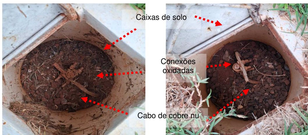
Figuras 273 e 274: Conexões oxidadas entre a malha de terra e a haste nas cx. de solo.
