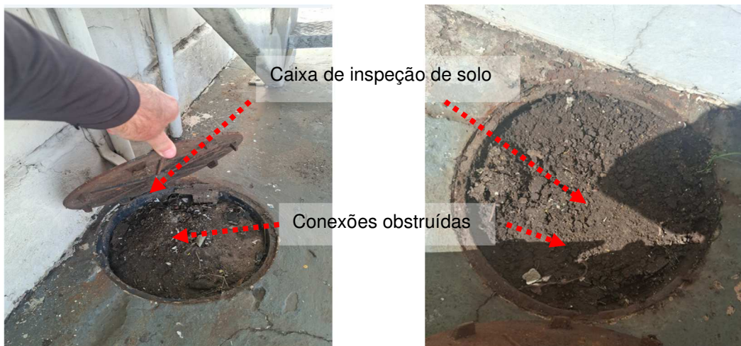
Figuras 584 e 585: Caixas de inspeção de solo - Conexões obstruídas/oxidadas.
