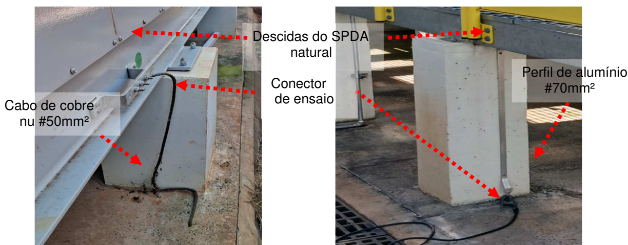
Figuras 638 e 639: Sistema de descidas do tipo natural existente.
