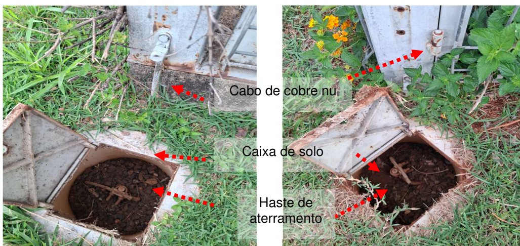
Figuras 269 e 270: Conexões entre a malha de terra e a haste no interior da cx. de solo.
