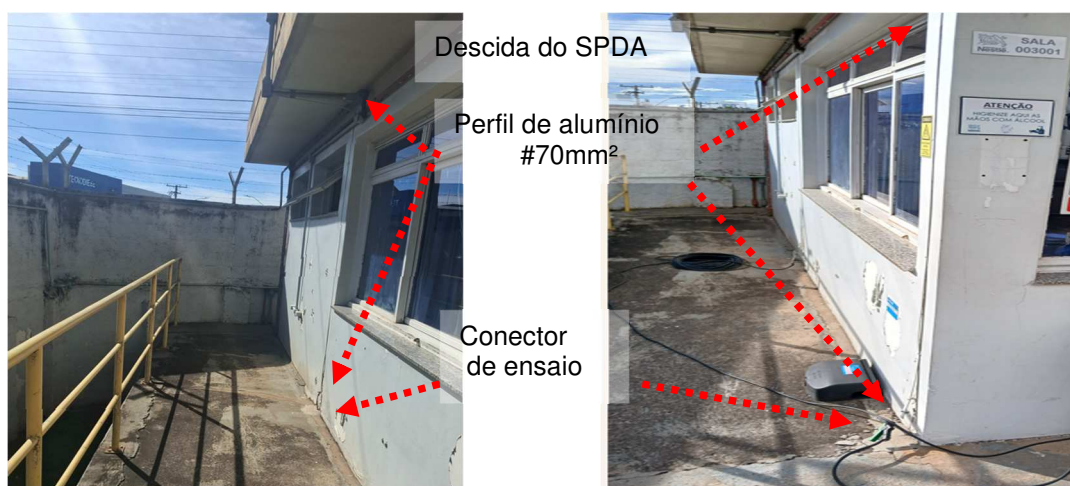
Figuras 352 e 353: Descidas existentes área dos vestiários.
