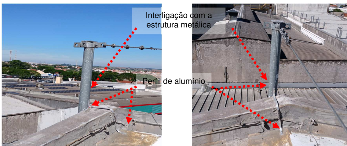
Figuras 466 e 467: Interligação estrutura e malha captora através de perfil alumínio #70mm 2 .
