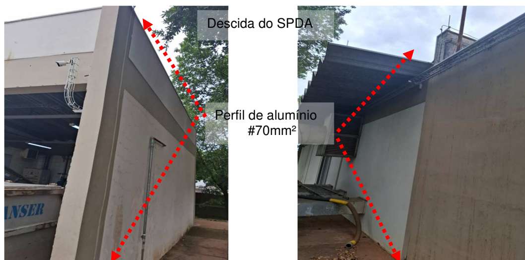
Figuras 64 e 65: Sistema de descidas do SPDA.
