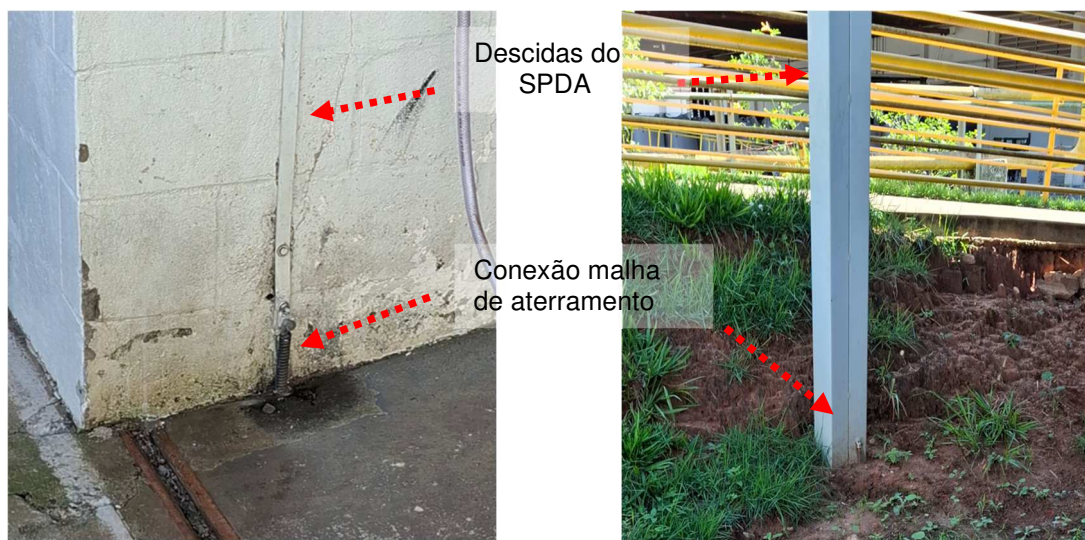
Figuras 256 e 257: Sistema de aterramento.
