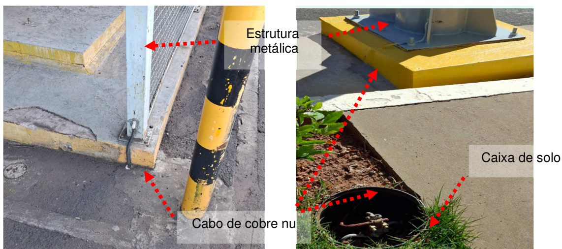
Figuras 134 e 135: Conexões entre a malha de terra e estruturas metálicas
